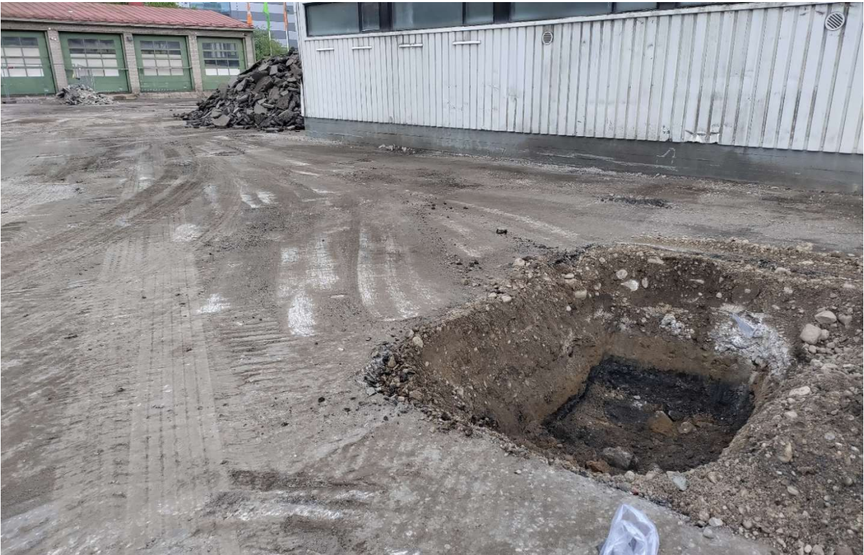
Kuva 3. Alueen laajempaa koekuopitusta, kuvassa nähtävissä raskasmetallipitoinen tumma kerros louheen päällä.
