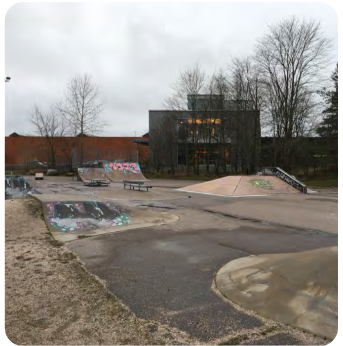
Kuva 59. Kartanonhaan skeittipaikan kuluneita rakenteita ja pinnoitteita
