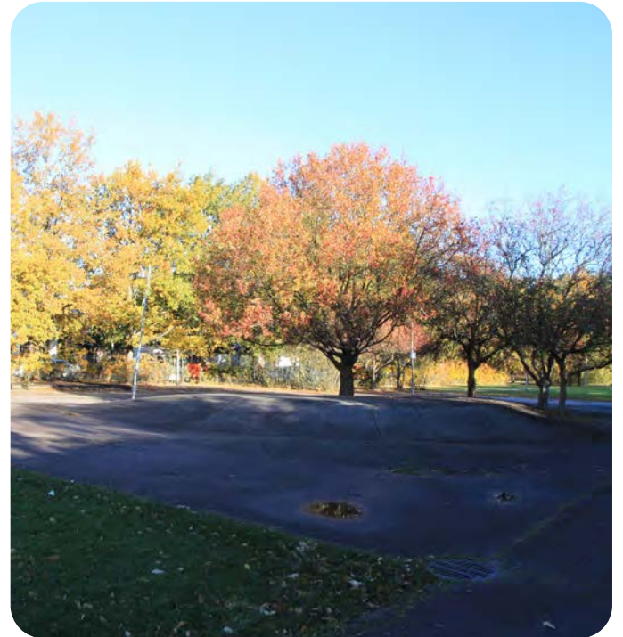
Kuva 81. Asfalttipintaisessa keskusaiheessa on painumia
