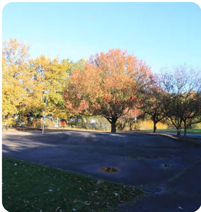
Kuva 81. Asfalttipintaisessa keskusaiheessa on painumia
