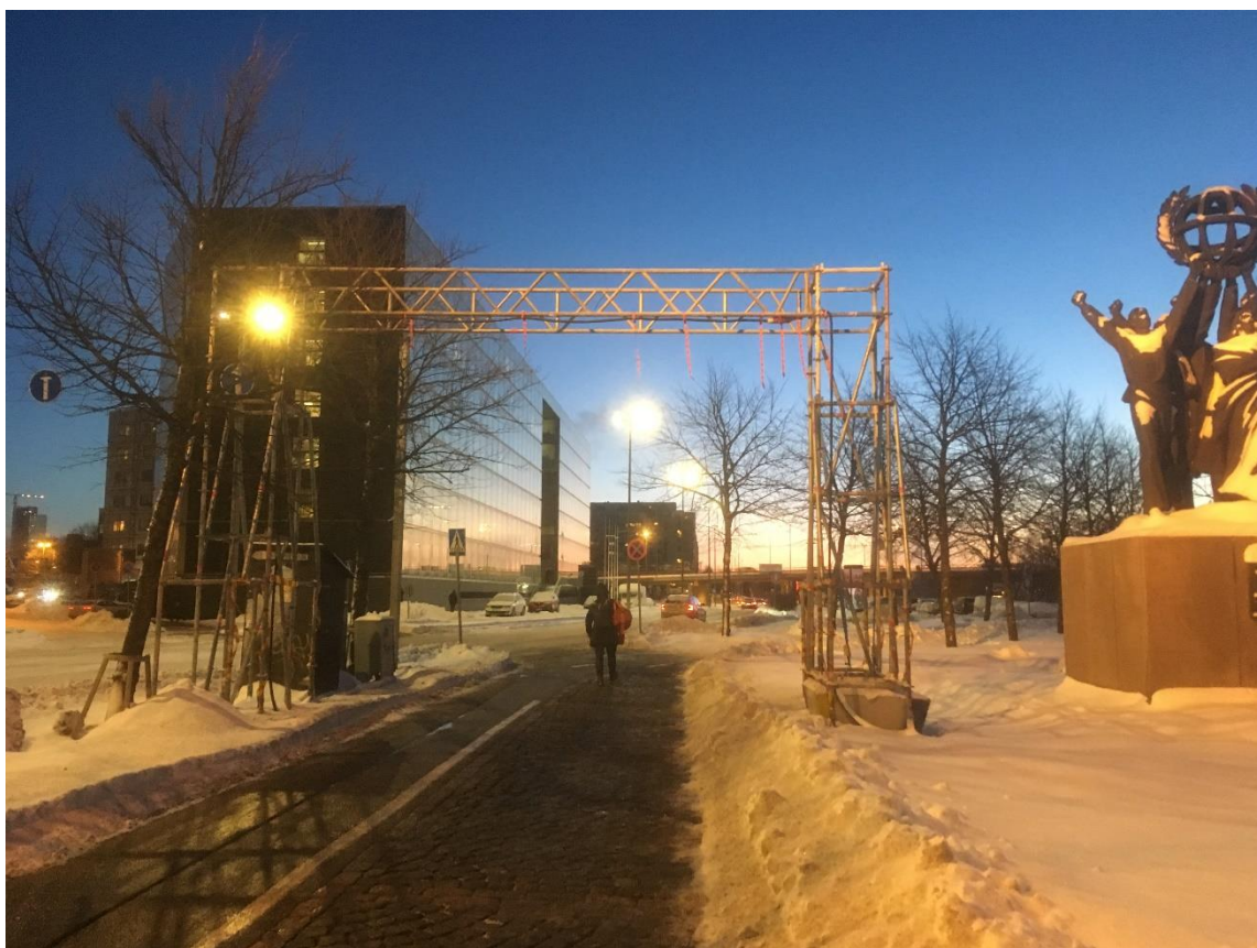
Kuva 71 Pyörätien ja jalkakäytävän yli johdettu kaapeli Hakaniemenrannassa
