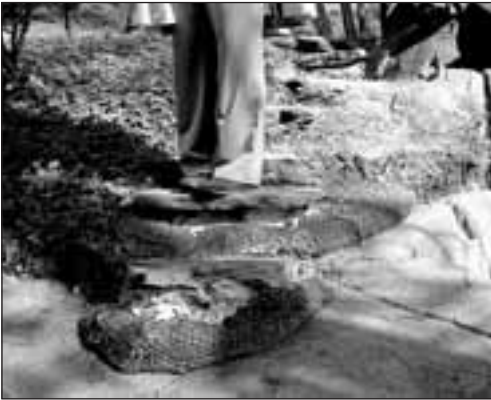
I. luokan hoitotasoon nähden on paikoin parantamisen varaa
