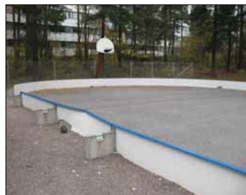
Leikkipuisto Maasälvän peliarena on huonossa kunnossa ja tulisi uusia.
