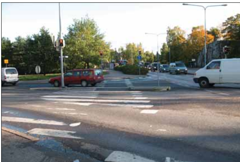
Suojatiemaalaukset ovat kuluneet Meripihkatien ja Pihlajamäentien risteyksessä.
