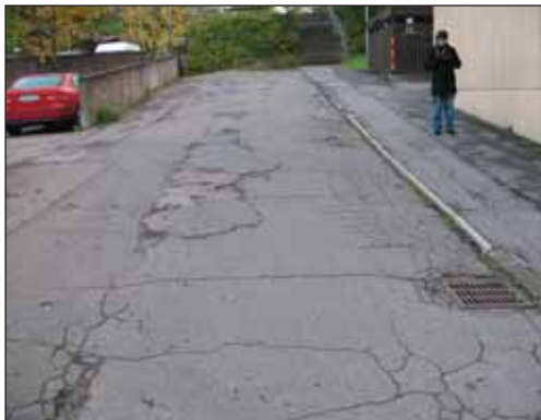
Hattelmalanpolulla on vakavaa päällystevauriota.
