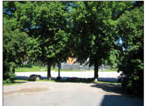
Kivitorpantien kääntöpaikalta puuttuvat reunakivet.
