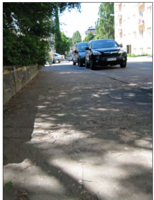
Päällysteen pintavaurioita Solnantien jalkakäytävällä
