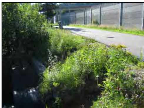
Ojan ylityskohtaan tarvitaan kaide.
