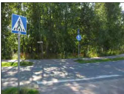
Suojatien maalaukset ovat kuluneet.
