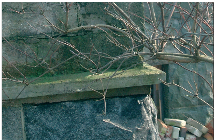
Kuvat 15. Valokuvia nykytilanteesta. 15a. Kasvillisuus peittää raunion, kuva rakennuksen keskeltä. 15b. Ylätason sisääntulon laatoitus. 15c. Betoninen reunalista. 15c.
