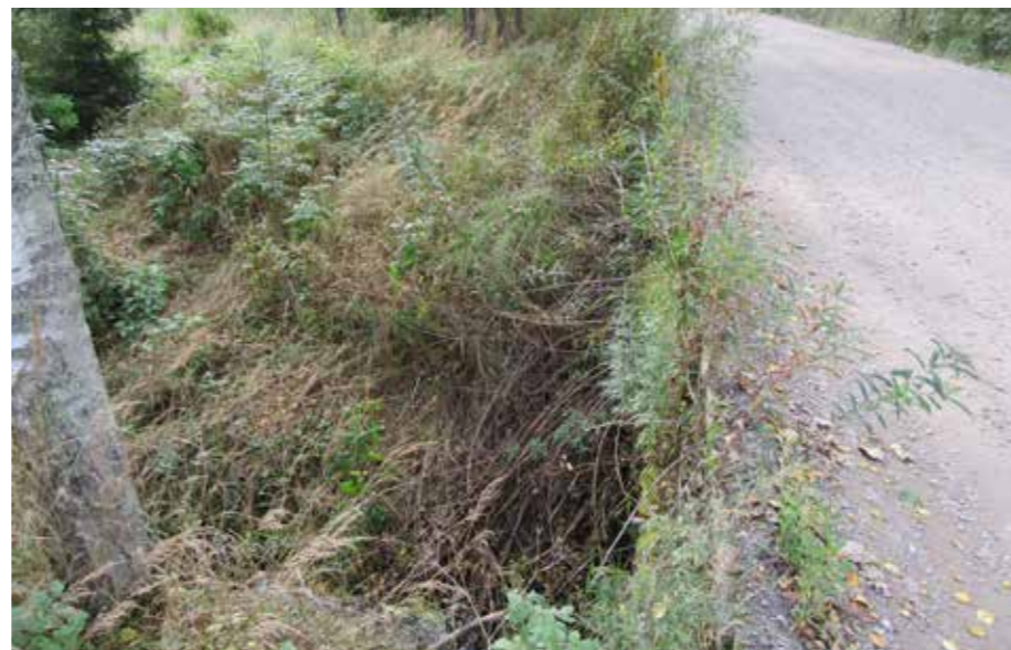
Uutelantien alittavan rummun kohdalla ei ole kaiteita vaikka tieltä ojaan on syvä pudotus.
