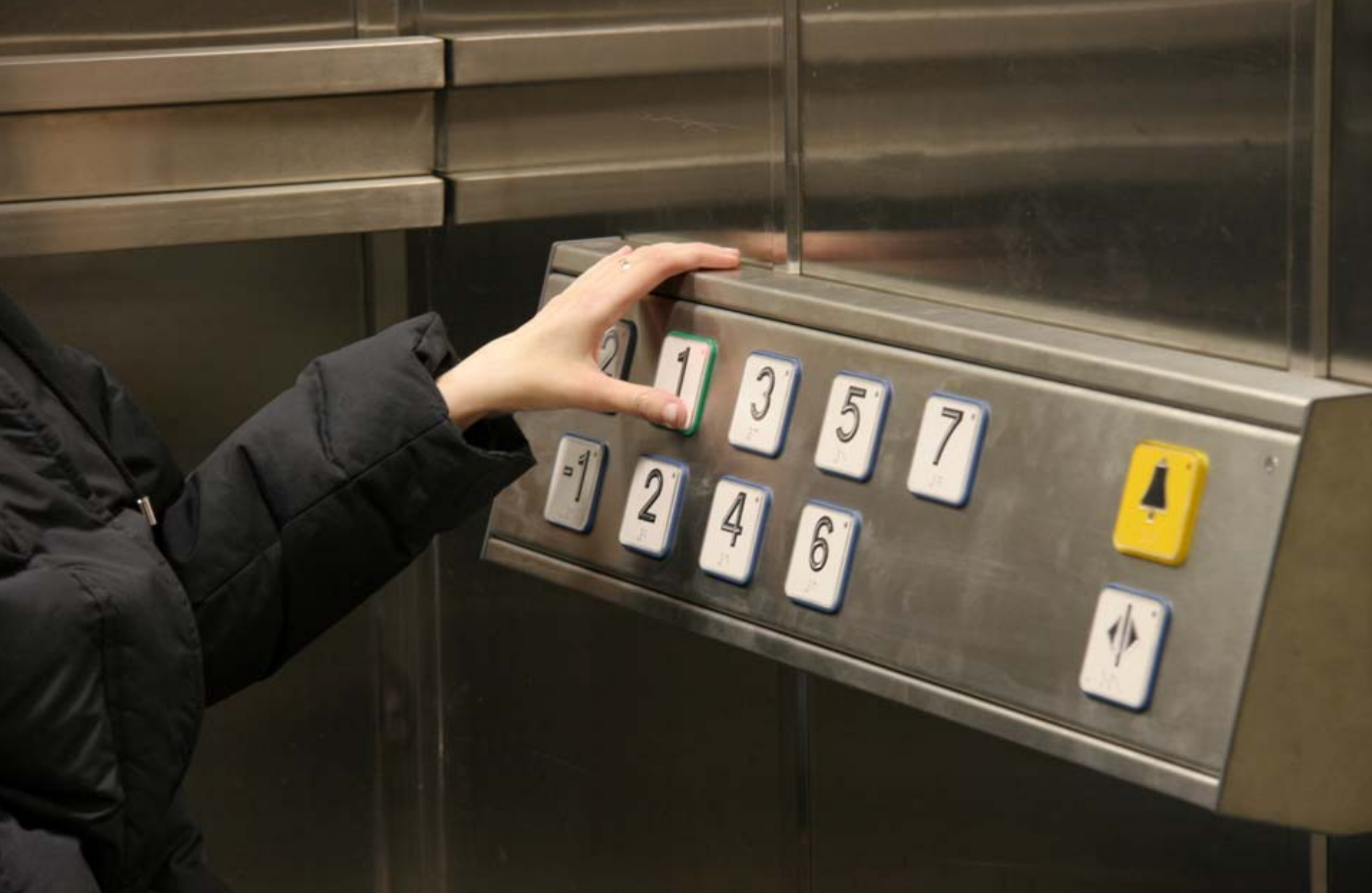
16. Alkuperäiset hissikorin painonapit sijaitsivat liian korkealla. Uudet alas sijoitetut painonapit on lisätty myöhemmin. (Siltasaarenkatu 4)
