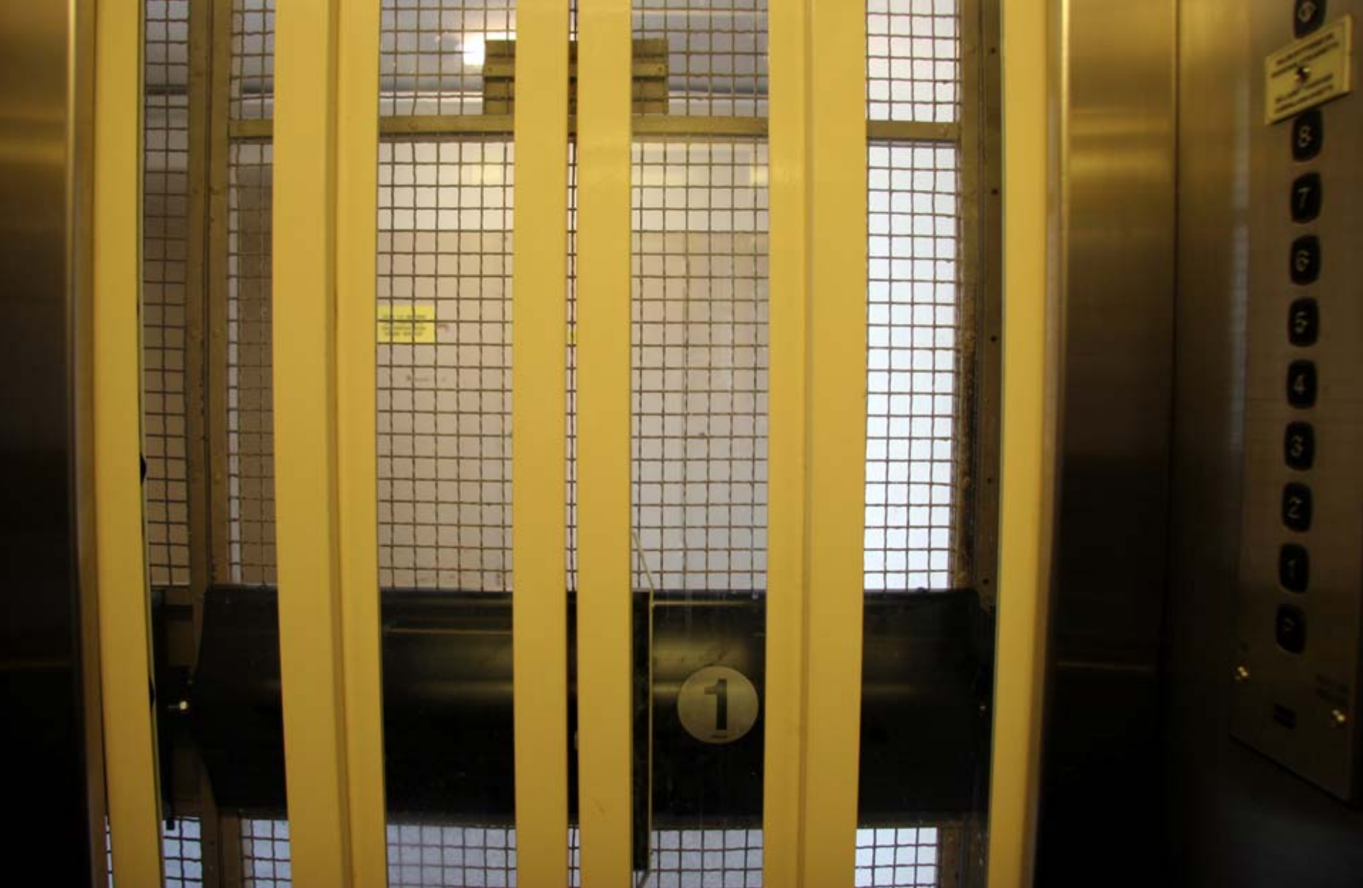
20. Hissikorin automaattiset lasiruuduin varustetut liukuovet on vaihdettu veräjän paikalle kun hissi on modernisoitu. Hissiä on miellyttävämpi käyttää kun sieltä näkee ulos. (Kuortaneenkatu 13)
