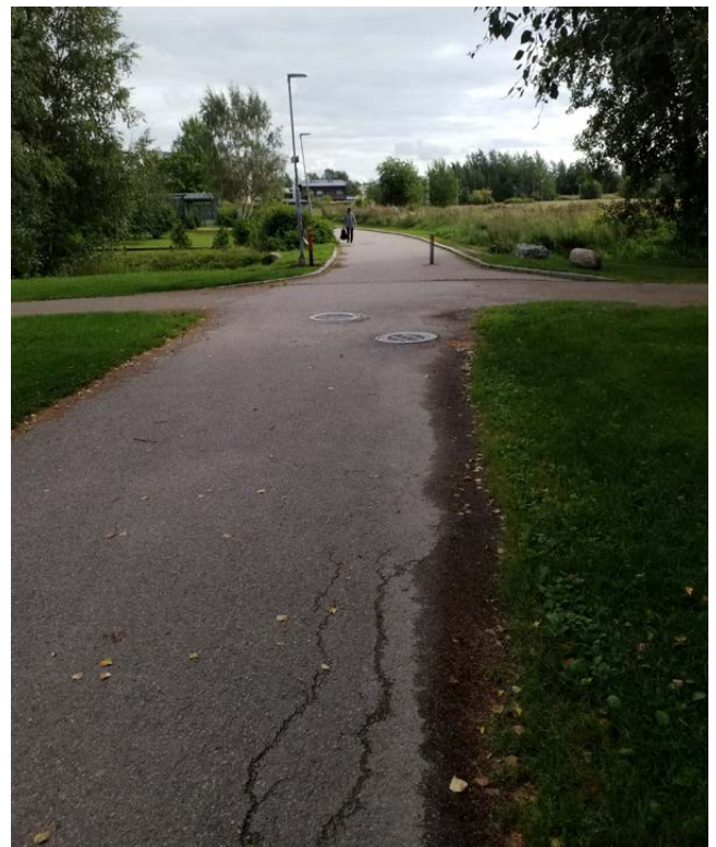
Kuva 84. Sammalpolun rakenteelliset vauriot ja pintamateriaalit kunnostetaan.
