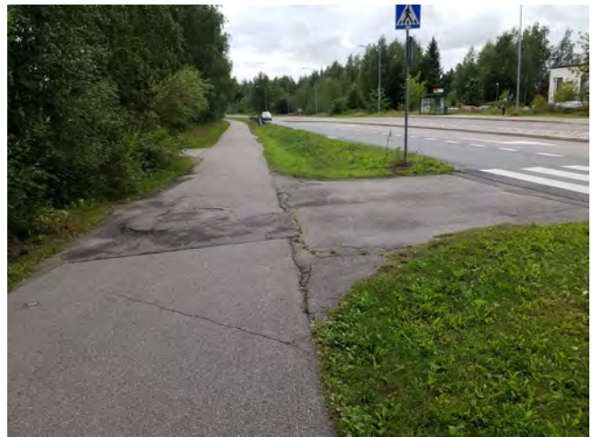
Kuva 87. Malminkaaren pintamateriaalivauriot kunnostetaan.
