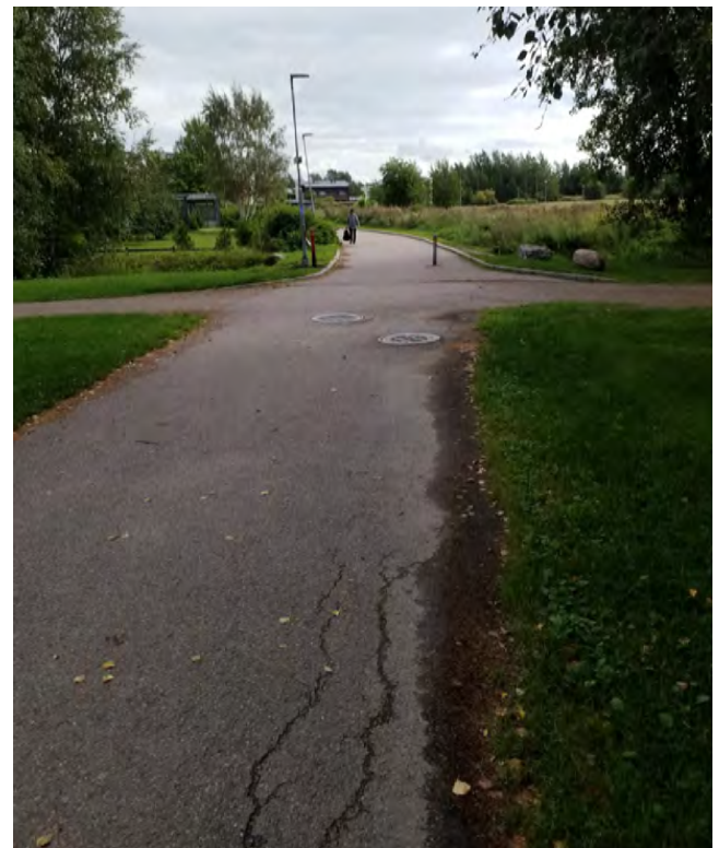
Kuva 84. Sammalpolun rakenteelliset vauriot ja pintamateriaalit kunnostetaan.
