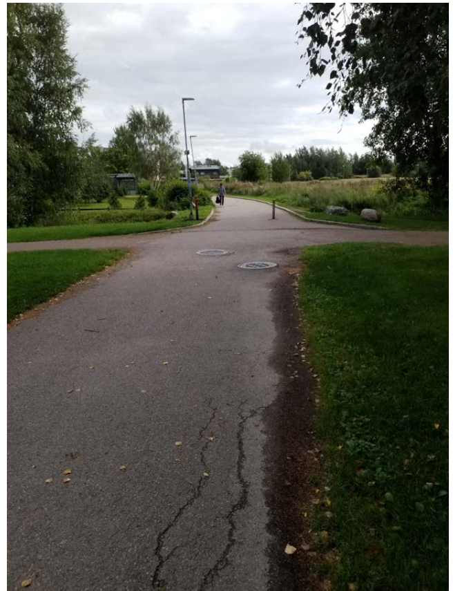
Kuva 81. Sammalpolun rakenteelliset vauriot ja pintamateriaalit kunnostetaan.
