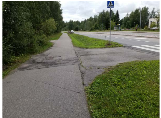
Kuva 84. Malminkaaren pintamateriaalivauriot kunnostetaan.
