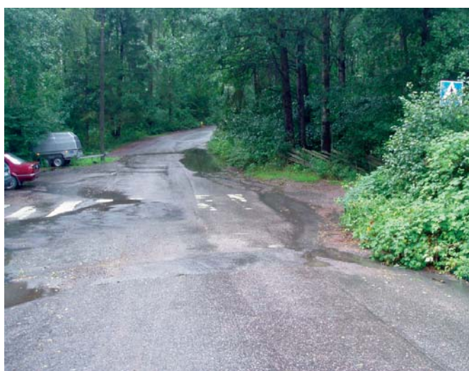
Sadevesiviemärointi on paikoitellen puutteellinen.
