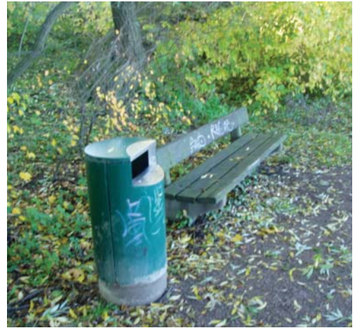
Penkit ja roska-astiat ovat yleisesti vanhoja ja huonossa kunnossa.
