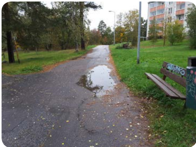
Kuva 82. Raitilla on painumia ja puiden juuret rikkovat päällysteen.
