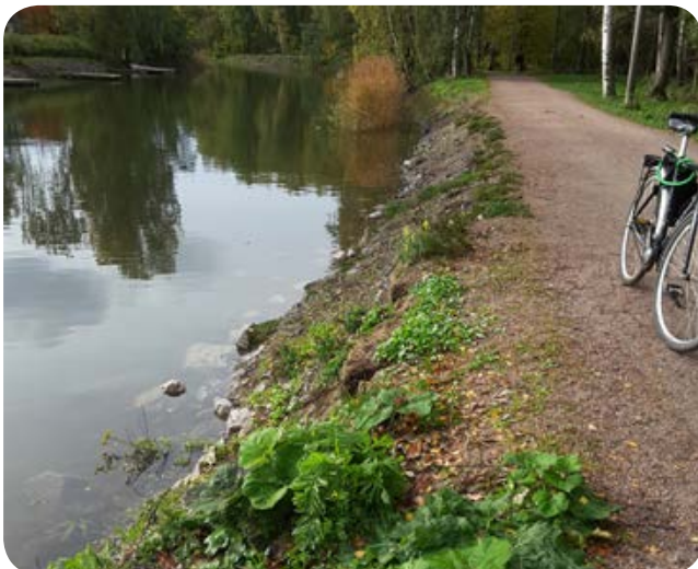
Kuva 75. Nykyisessä luiskassa ei ole suojausta.
