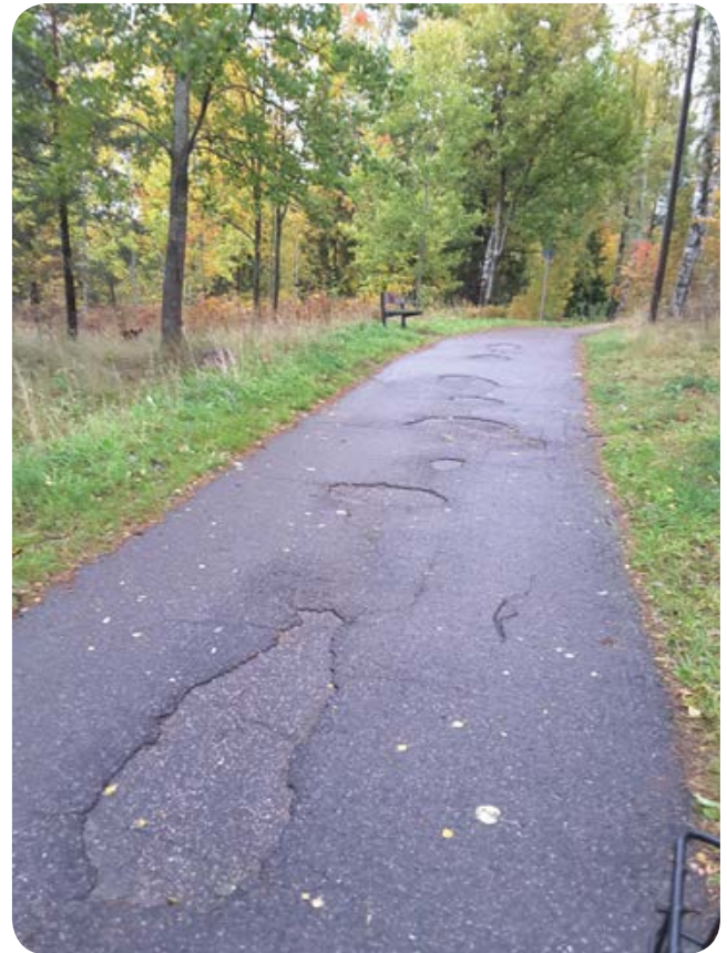
Kuva 80. Raitilla puiden juuret rikkovat päällysteen ja ohut päällyste purkautuu rakenteellisista ongelmista (routiminen) ja talvikunnossapidosta johtuen.
