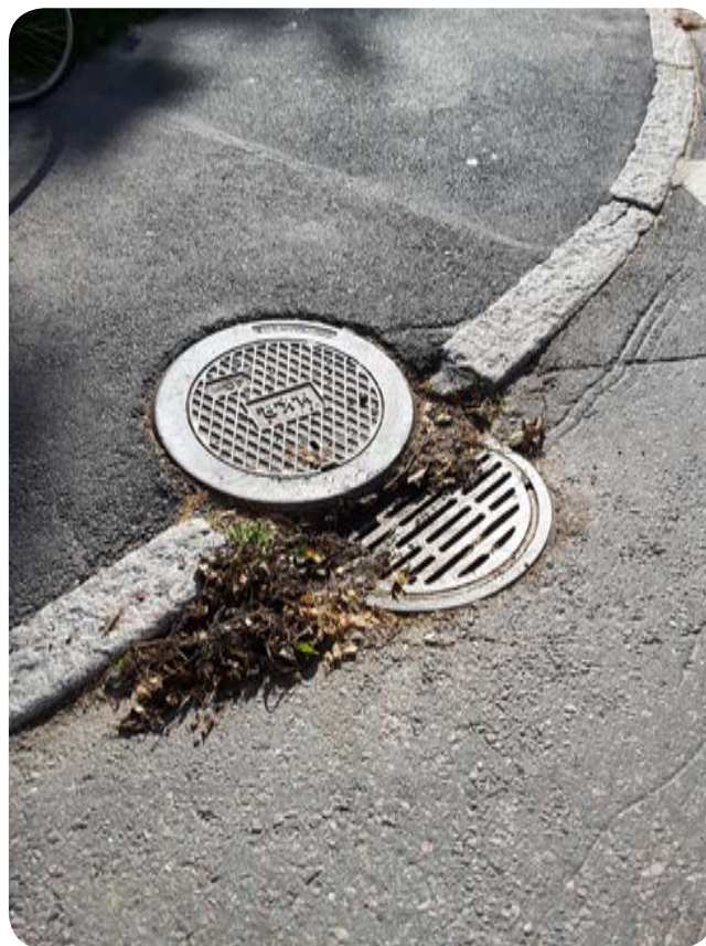
Kuva 49. "Limputettuja" sadevesikaivoja Susitiellä.
