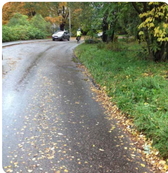
Kuva 69. Laaja reunapainuma, jossa pahimmassa kohdassa rakenteet ovat pettäneet. Asfaltti on levinyt painuman yhteydessä asfalttimakkaran päälle viheralueen reunassa.
