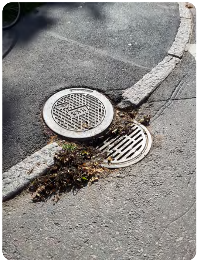
Kuva 46. "Limputettuja" sadevesikaivoja Susitiellä.
