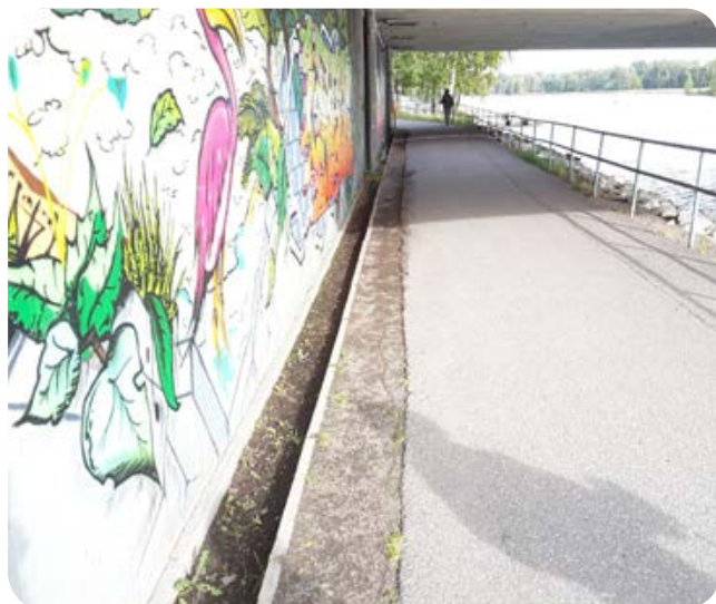
Kuva 74. Päällysteen rajautuminen kouruun ja kourun kunto.
