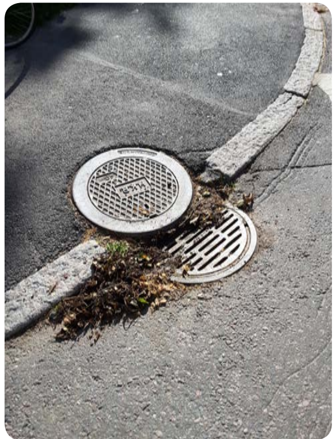
Kuva 49. "Limputettuja" sadevesikaivoja Susitiellä.
