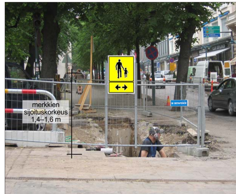
Kuva 3. Opasteet tulee kiinnittää niin, etteivät kiinnitysrakenteet aiheuta törmäys- tai kompastumisvaaraa.
