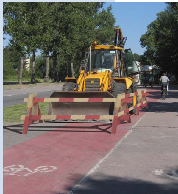
Kuva 2. Työkoneiden suojaus ei saa aiheuttaa jalankulkijoille tarvetta siirtymään ajoradalle.
