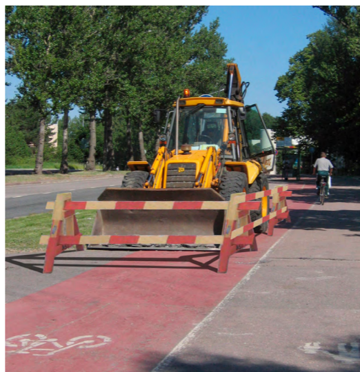
Kuva 2. Työkoneiden suojaus ei saa aiheuttaa jalankulkijoille tarvetta siirtyä ajoradalle.
