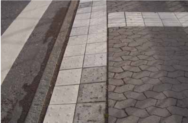
Kuva 16. Osassa Itäkeskuksen opaslaatoista metallilevy on lähtenyt kokeilujakson aikana kokonaan irti betonialustasta ja myös maalipinta on lähtenyt pois.
