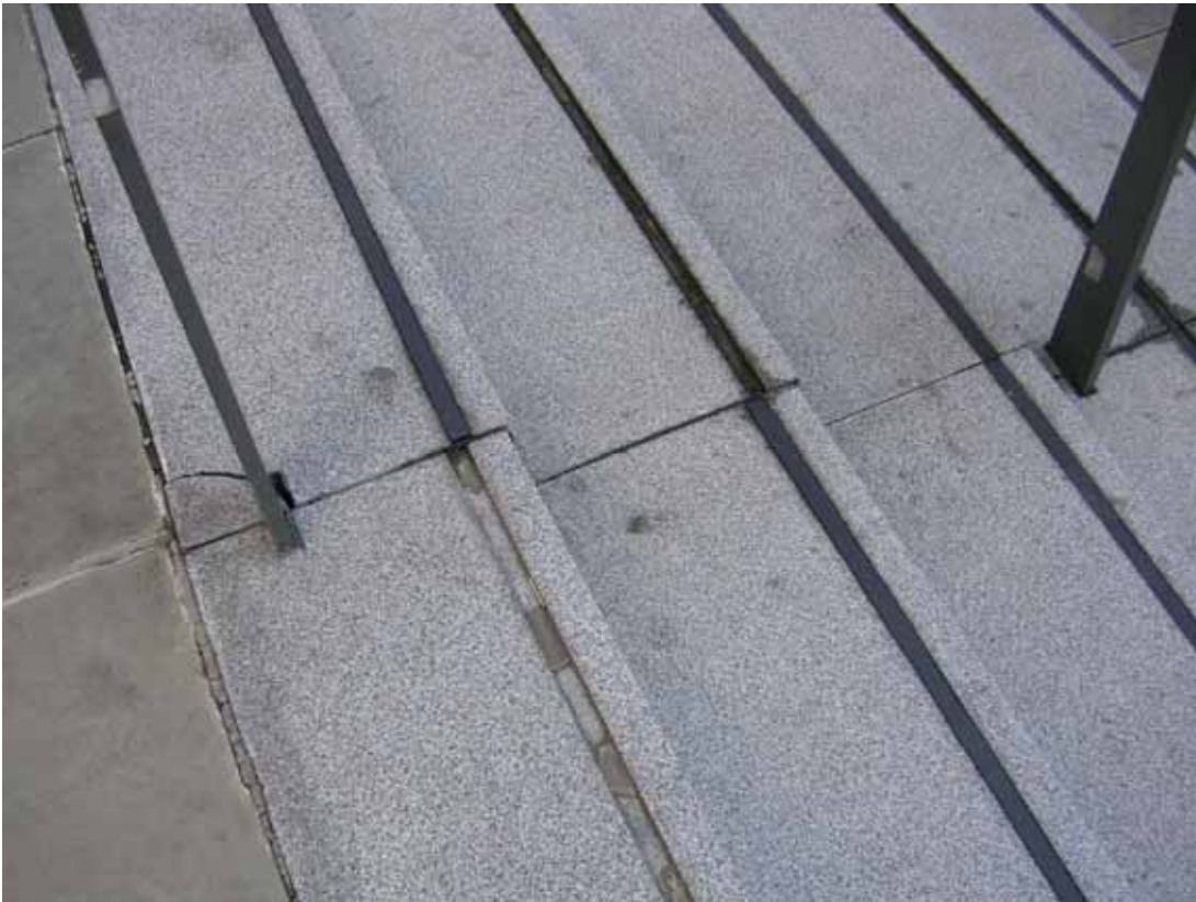
Kuva 25. Irlannissa luonnonkiviportaiden etureunassa on käytetty osittain upotettua kontrastinauhaa, joka on kuvan kohteessa osittain irronnut.
