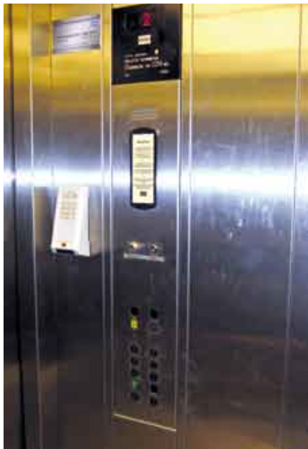
Kuva 14. Kulkukortinlukija on asennettu liian korkealle. (Kuva: JS)
