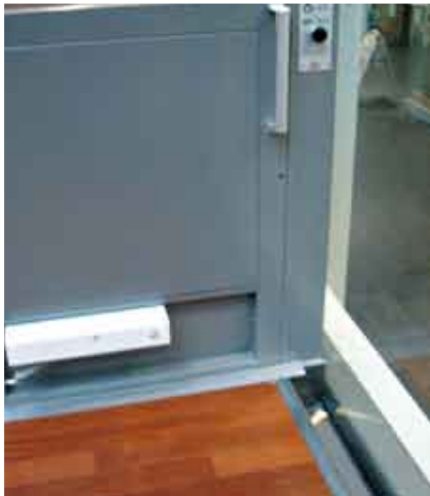
Kuva 31. Seinän vieressä on luiskahtamisvaaran aiheuttava rako. (Kuva: AR)
