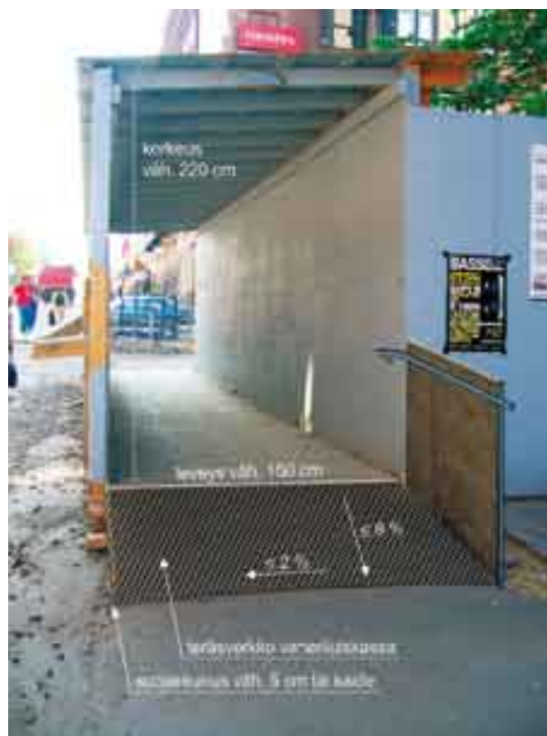
Kuva 52. Esimerkki katetusta työmaa-aikaisesta jalankulkuväylästä ja luiskasta. Luiskan sivuseinäke ohjaa kulkijan selkeästi pois ajoradalta. Teräsverkko vaneriluiskan päällä toimii talviolosuhteissa. (Kuva: SuRaKu)
