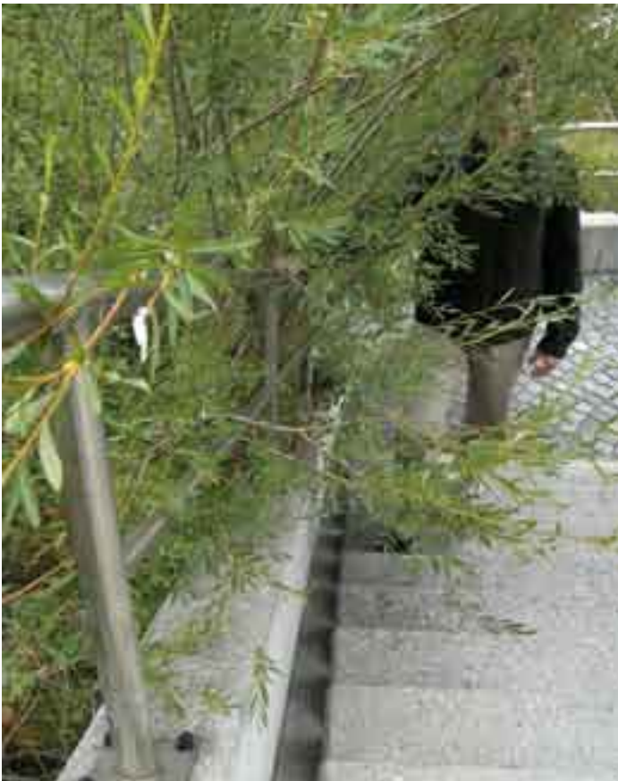
Kuva 38. Hoitamaton kasvillisuus estää ulkoportaiden käsijohteen käytön ja aiheuttaa törmäysvaaran. (Augsburg, Saksa. Kuva: AR)
