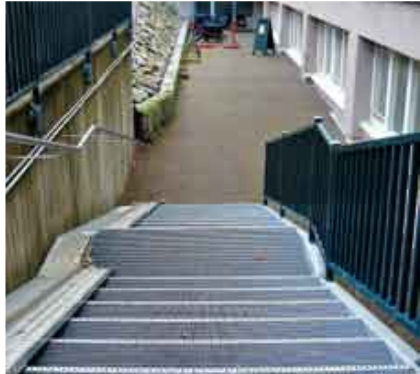
Kuva 23. Ulkoportaiden reunassa oleva polkupyöräluiska on vaarallinen. (Kuva: NK)
