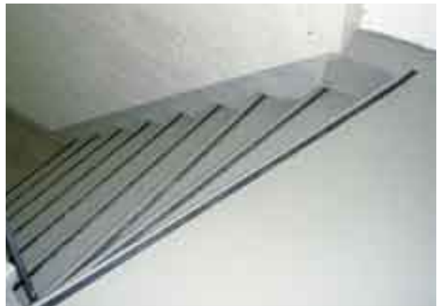
Kuva 9. Porraskelmissä on hyvät kontrastimerkinnot, mikä auttaa havaitsemaan myös portaan muuttuvan muodon. (Kuva: AR)
