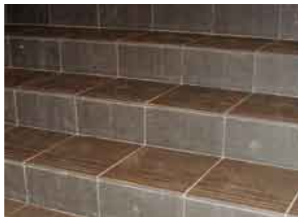
Kuva 10. Portaissa on heikko valaistusvoimakkuus ja askelmat eivät hahmotu selkeästi. (Kuva: AR)
