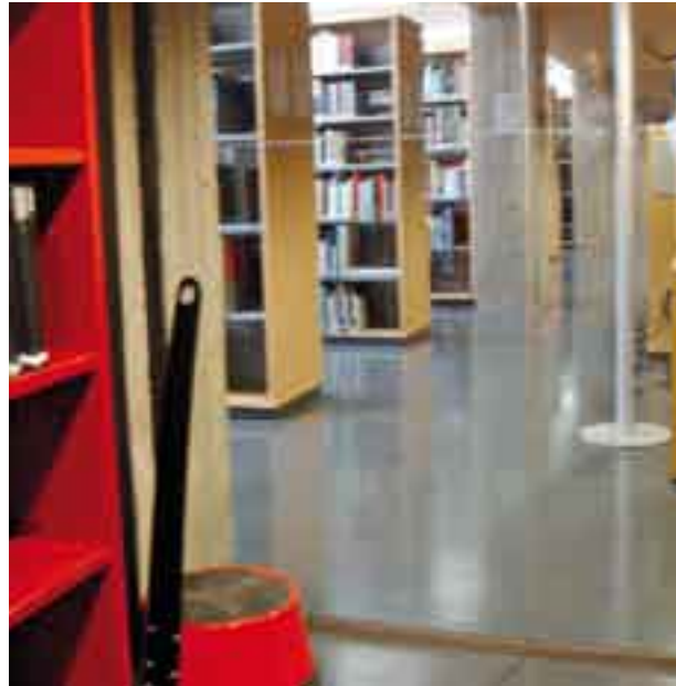
Kuva 33. Lukusalin lasiseinän kontrastiraita ei ole riittävä. (Kuva: NK)
