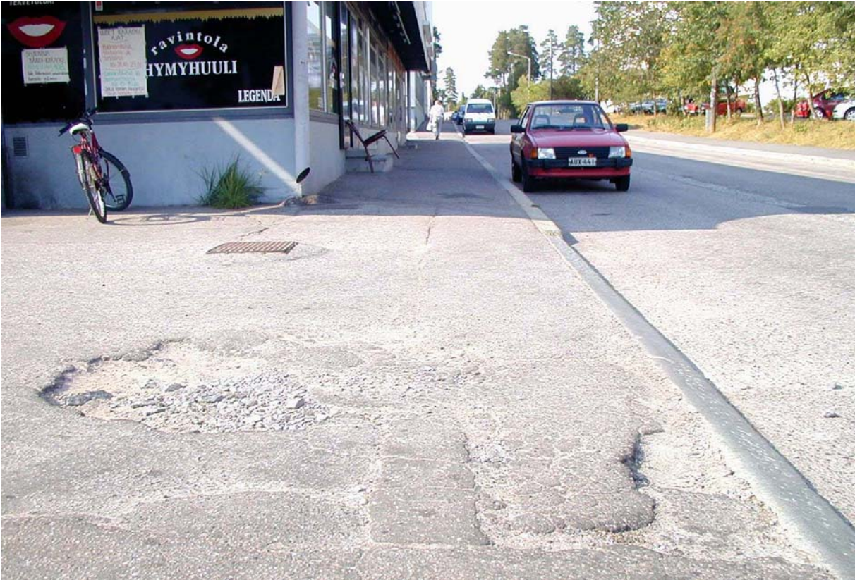
Kuva 7.4 Kiireellisesti parannettava pahasti vaurioitunut asfalttipäällyste Ulappasaarentiellä.
