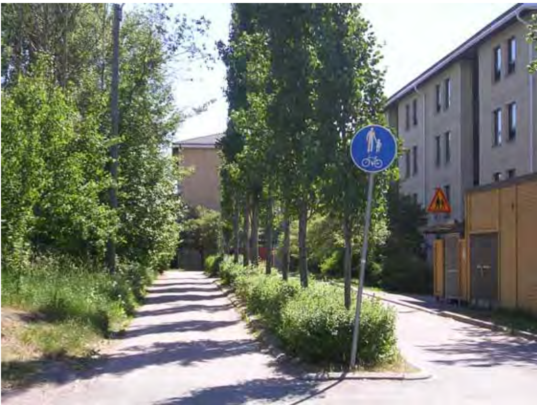
Kuva 36. Karviaisrinteen jalankulkuväylän päällyste on pahasti painunut ja epätasainen. Ala-Malmin toimenpidekartan kohta 6.
