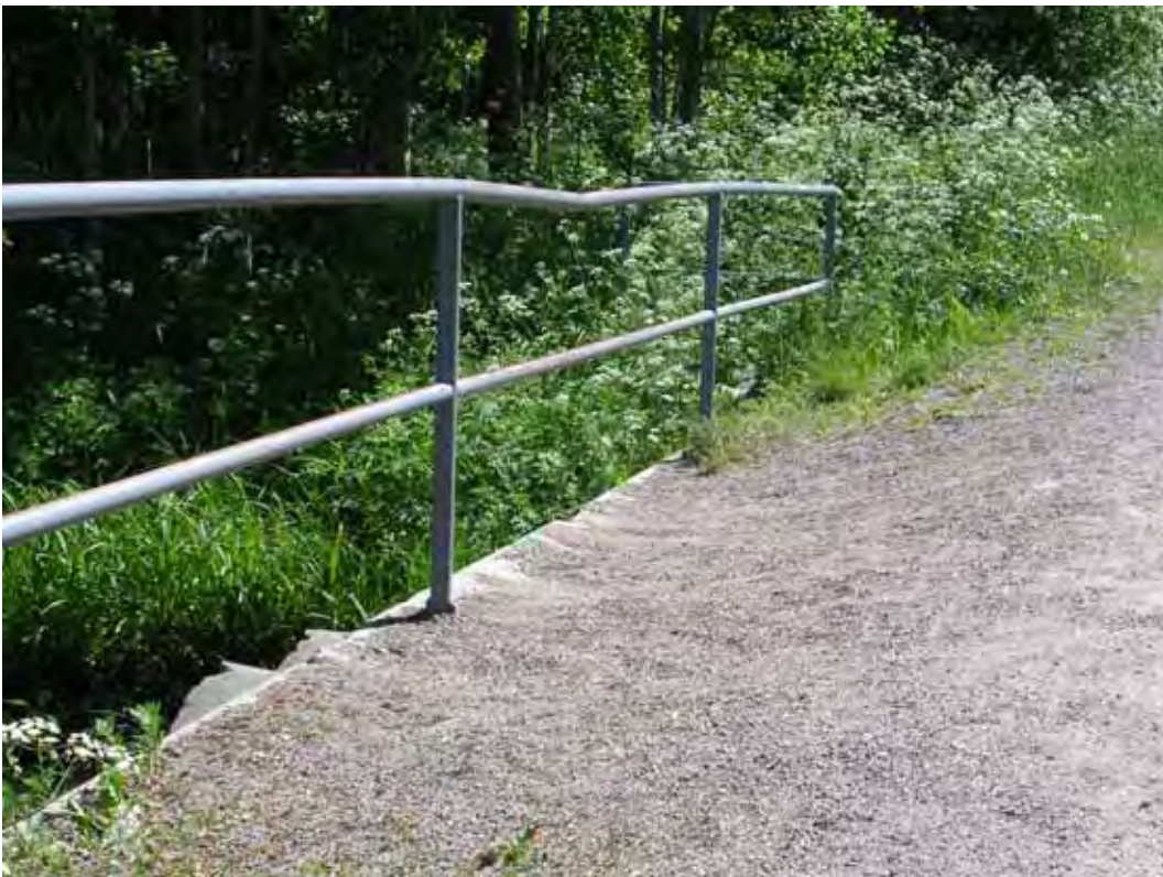
Kuva 33. Karviaismäen aluepuistossa on Longinojan ylittävä silta, jonka kohonnut keskialue aihe- uttaa kaatumisvaaran. Myös sillan kaiteet pitää uudistaa ohjeiden mukaisiksi.
