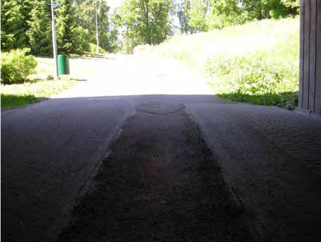
Kuva 23. Radan ja Malminkaaren alikulku Pukinmäenkaaren kohdalla on hämärä ja varsinkin pohjoispäässä on päällysteessä pahoja painumia. Valaistuksen parantaminen on Helsingin Energialle kuuluva toimenpide. Ala-Malmin toimenpidekartan kohdat 2 ja 8.
