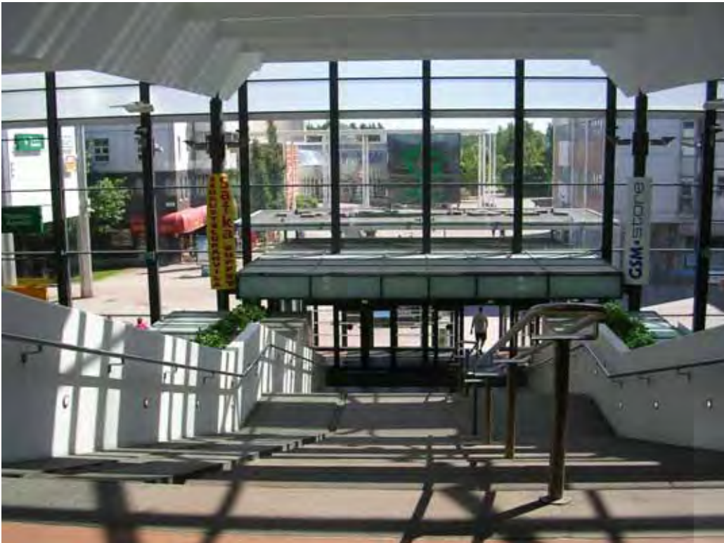
Kuva 32. Liikekeskuksen Ala-Malmin puolen portaisiin tulee lisätä 70 cm:n korkeudelle käsijohde ainakin keskikaiteeseen, lastenvaunuluiska tulee erottaa portaista käsijohteella ja porrasaskelmien reunaan tulee lisätä 3-4 cm leveä kontrastivärinen raita. Toteuttaminen kuuluu Malmintorin kiinteistöyhtiölle. Malmin keskustan toimenpidekartan kohta 4.
