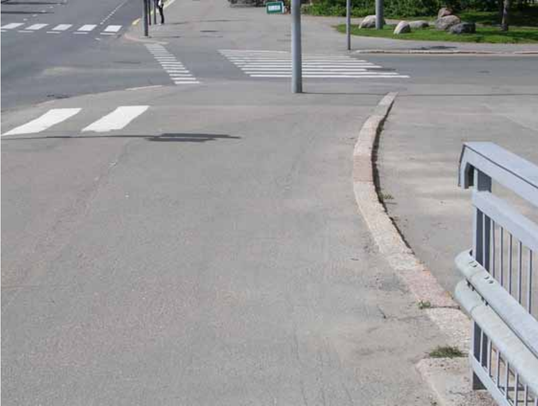
Kuva 13. Lauttasaarentie 1:n tontin ja jalkakäytävän välissä on puistokäytävä, joka on tasaukseltaan alempana. Tasauksen nostolla voitaisiin poistaa kompastumisvaaran aiheuttava kynnyks. Toimenpidekartan kohta 15.
