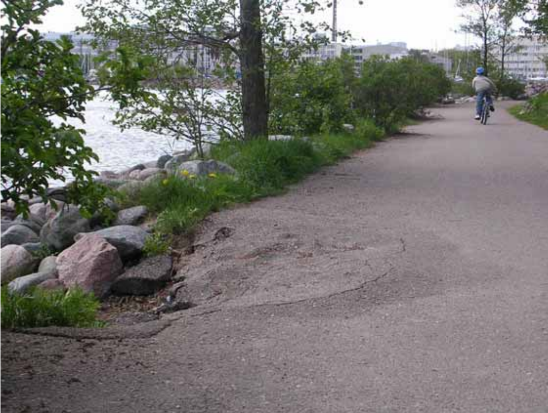
Kuva 28. Lanakujan reunassa, vanhan laiturin kohdalla oleva vaarallinen painanne pitää tasoittaa. Toimenpidekartan kohta 18.
