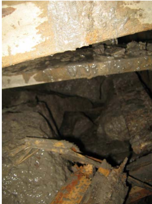
Kuvat 5. Trukikorjaamon kohdalla alapohjalaatan alapuolella on muottilautoja ja louhetta.
