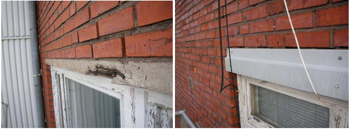
Kuvat 23 ja 24. Vasemman puoleisessa kuvassa on esitetty ikkunan ylityspalkin vaurioita. Oikean puoleisessa kuvassa on esitetty rakennuksen eteläsivulla pellillä päällystetty ikkunan ylityspalkki. Ikkunan ylityspalkit on pellitetty rakennuksen etelä- ja itäisivulla.
