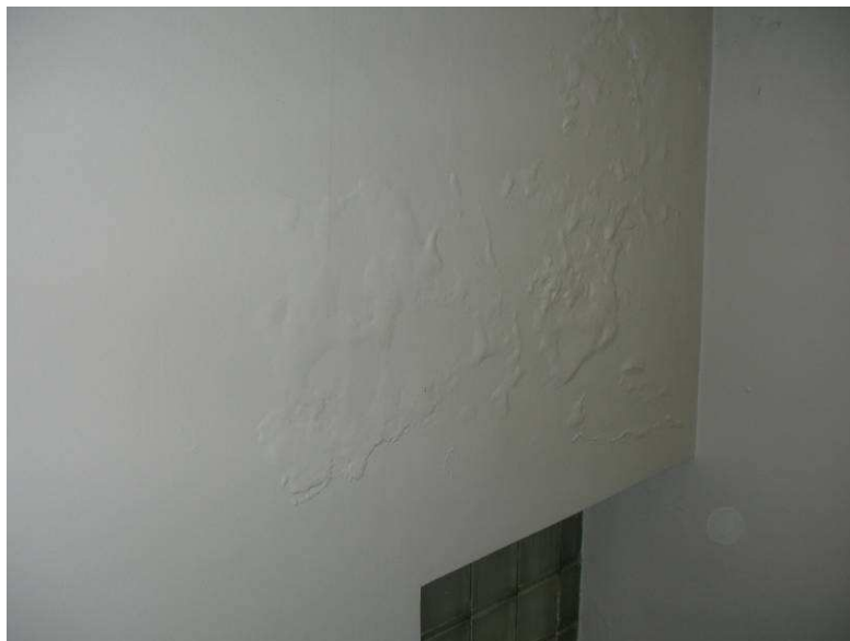
Kuva 6. Rakennuksen eteläpäädyssä oli havaittavissa pinnoitteiden kosteusvaurioita ja lisäksi seinärakenne oli kyseisillä alueilla pintakosteusilmaisimella tarkastettuna märkä.
