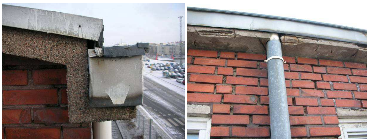
Kuvat 21 ja 22. Vasemman puoleisessa kuvassa on esitetty räystään betonirakenteen vaurioita syöksytorven kohdalla. Syöksytorvi on aiemmin vuotanut ja tämän vuoksi myös tiilimuuraus on vaurioitunut.
