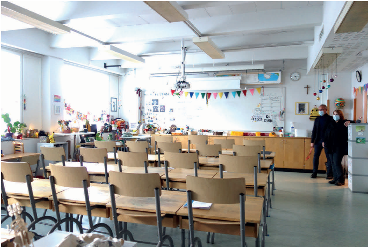
▲▼ 3. kerroksen luokkahuone itään päin. Sisäkatossa on näkyvissä palkit. Tässä luokkahuoneessa palkkien välissä on alkuperäisen näköistä reikäkipsilevyä, suurimmassa osassa luokkia kattolevyt ovat uudempia. JKMM 2022.
