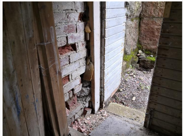
Tiilimuuratun perusmuurin vaurioita pääsisäänkäynnin viereisellä kellaritasolla.
