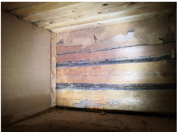
Hirsirunkoa näkyvissä huoneiston eteisen ulkoseinässä.
