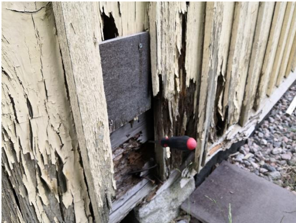
Paikallinen lahovaurio alimmaisessa hirsikerrassa.
