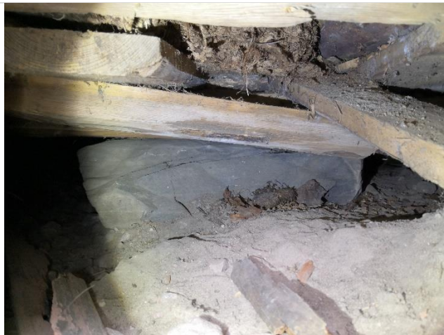
Ryömintätalassa alapohjarakenteen aluslaudoitus on osittain irronnut.
