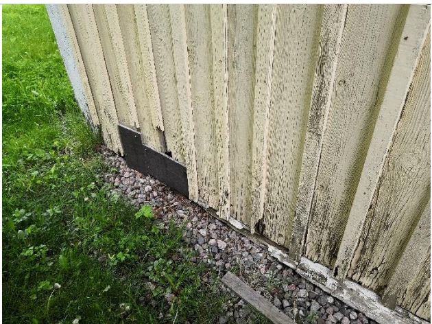
Julkisivuverhousta on paikattu vanerilevyn palasilla ja maanpinta on kiinni verhouksen alareunassa.
