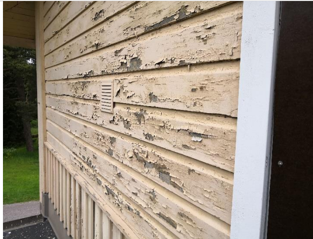
Julkisivujen maalipinnan vaurioita.
