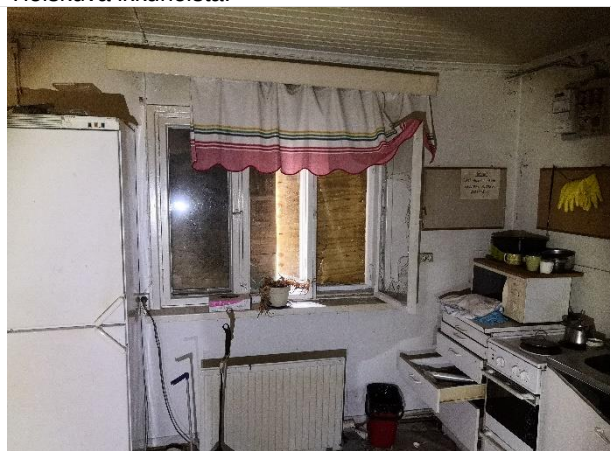
Ikkuna on rikottu.
