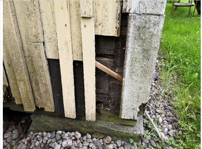
Hirsirunkoa näkyvissä julkisivuverhouksen vaurioiden takaa.
