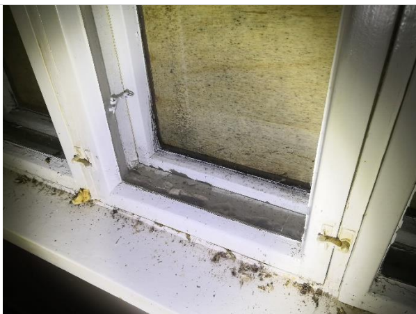
Karmin välitilan maalipinta irtoilee paikoin.
