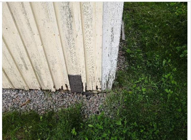
Julkisivuverhouksen vaneripaikkauksia ja maanpinta lähellä verhouksen alareunaa.
