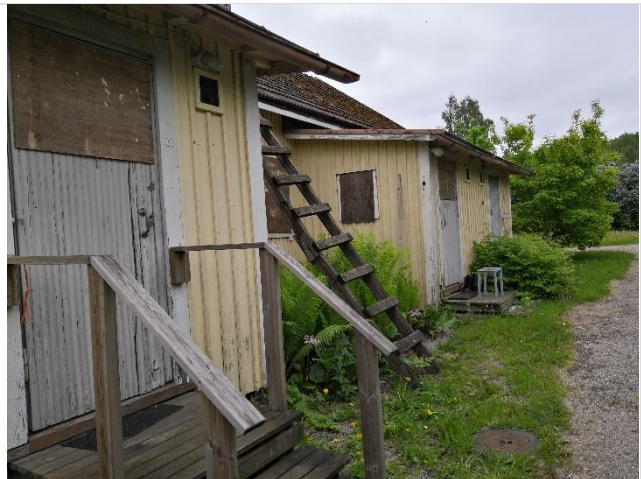
Maalipinta on kulunut ja osittain hilseillyt.
