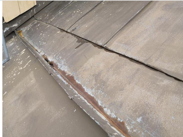
Ruostevaurioita katteessa jalkarännin liittymässä.
