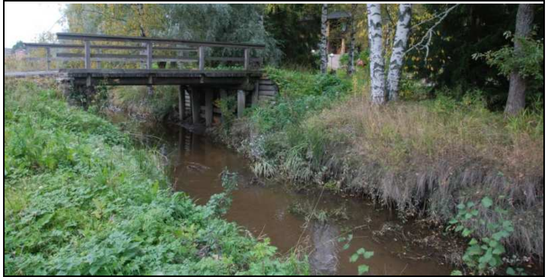
Kuva 7. Krapuojan uoma Purorinteen kohdalla. 7
