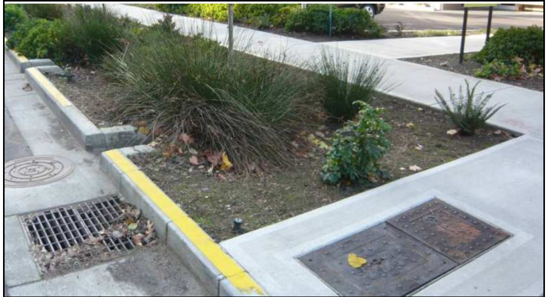
Kuva 35. Katualueen hulevesien hallintaa vihertaskuilla.
