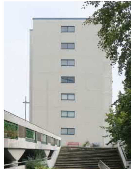
Hakaniemenranta 18 länsipääty on etäämmältä katsoen menettänyt täysin betoniurituksen tekstuurivaikutelman tasaharmaan pinnoitteen alle.
