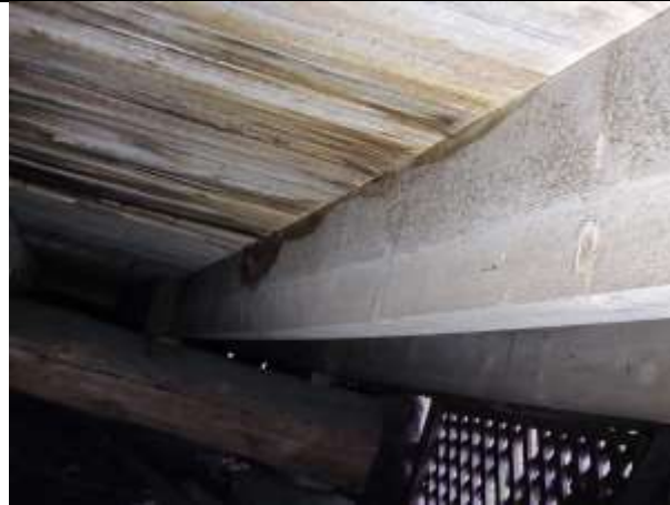
Kuva 10 Kylpyhuoneen alapuolella havaittavissa kosteusjälkiä kylpyhuoneen kohdalla.
