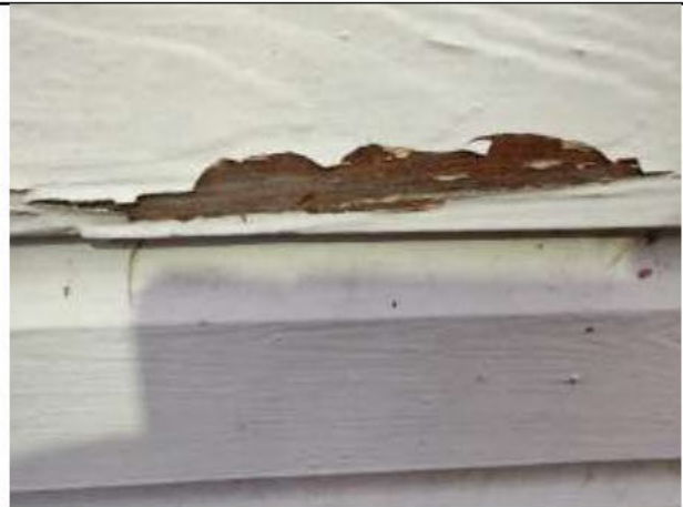
Kuva 20 laudoitus on maalin alla märkä.
