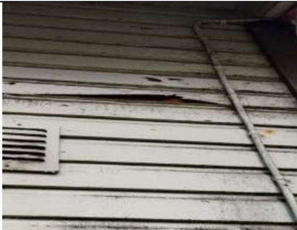
Kuva 19 maalipinta irtoilee seinästä.
