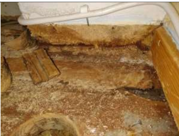
Kuva 5 seinän alaosassa on kosteuden aiheuttamaa vaurioitumista.
