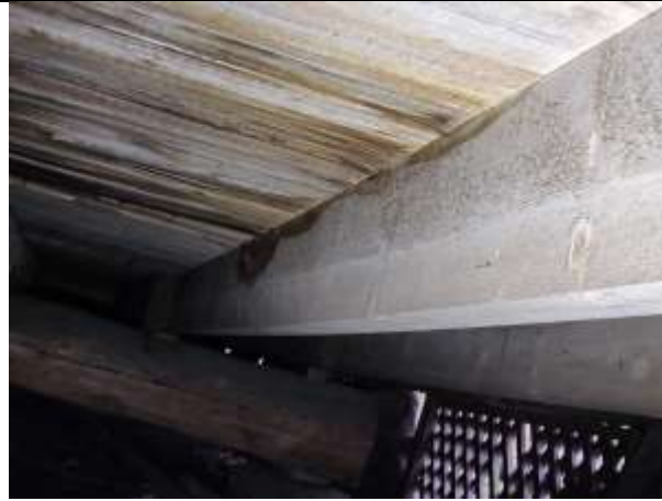
Kuva 10 Kylpyhuoneen alapuolella havaittavissa kosteusjälkiä kylpyhuoneen kohdalla.
