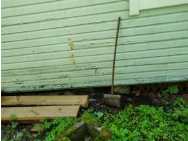
Alaliittymän vesilaudoissa lahovaurioita
