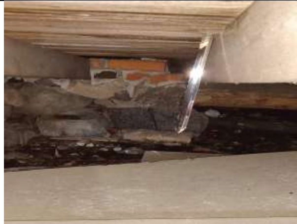
Kuva 8 Kuva rakennuksen alta, villaveitsi laudoituksen välissä.
