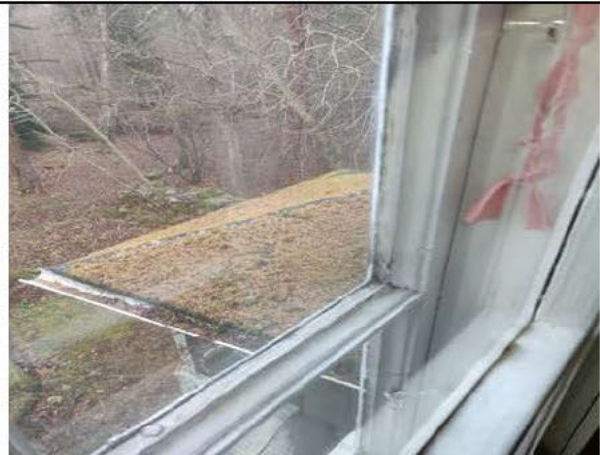
Kuva 22 katolla ja vesikouruissa likaa.
