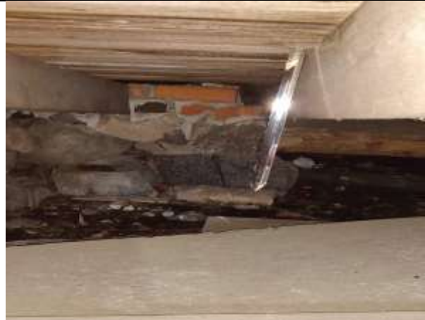
Kuva 8 Kuva rakennuksen alta, villaveitsi laudoituksen välissä.
