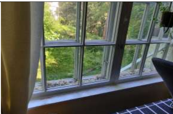
Ikkunapenkissä maali irtoillut
