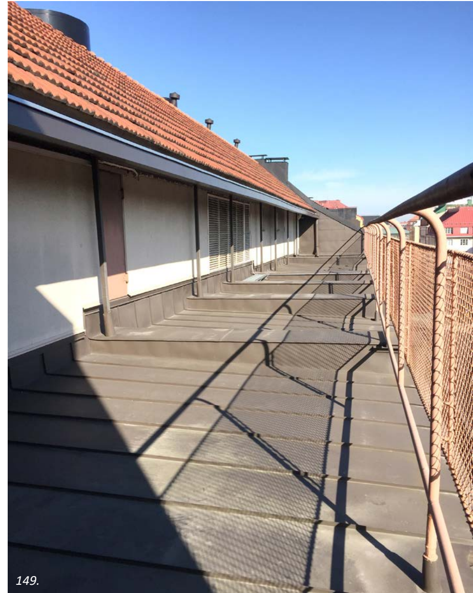
149. Fredrikinkadun puolella kattoterassin peltipinta on ruskea. Seinärappaus on uusittu yhtä aikaa muiden julkisivujen kanssa. Kaide on alkuperäinen.
