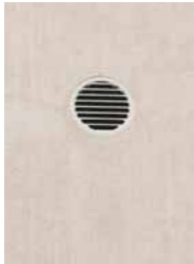
Rakennusajankohdalle epätavallinen korvausilma-aukko.
