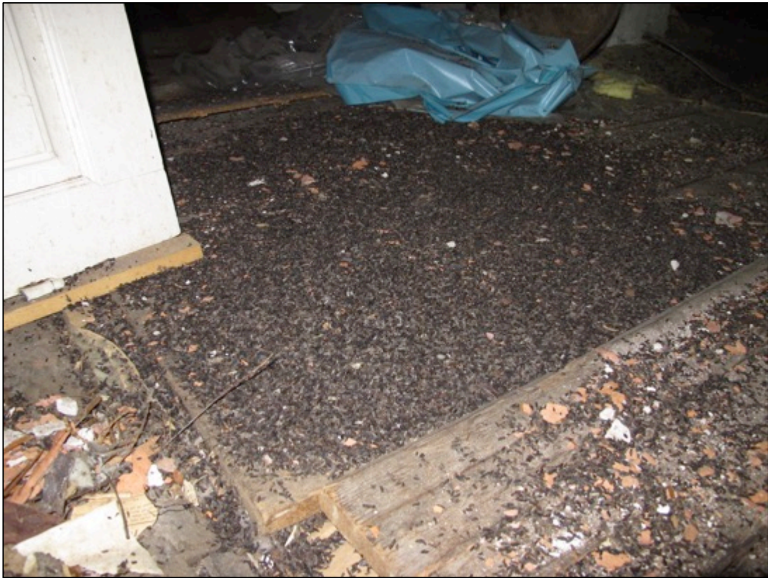
LIITEKUVA 1. Degerön kartanon ullakolla havaittu lepakoiden papanakerros, noin 3 cm paksu. Rakennus on lepakoiden lisääntymi-/levähdyspaikka.
