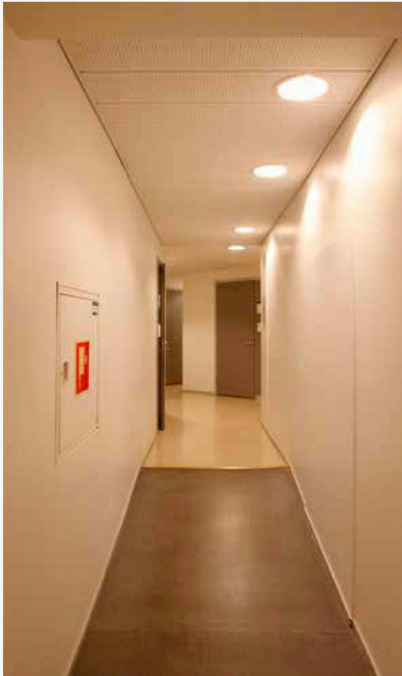
19. Kulmatalon ja piharakennuksen yhdyskäytävät rakennettiin jokaiseen kerrokseen 1970-luvulla. Tasoerot on hoidettu portaalla tai luiskalla.
