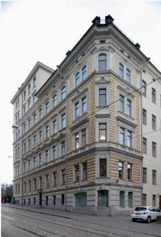
2. Kulmatalon pohjoiskulma karniisilista on katkaistu viisteen kohdalla. Toisen ja kolmannen kerroksen alkuperäiset parvekkeet on purettu.
