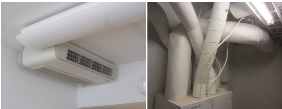
Ilmanvaihto- ja jäähdytystekniikkaa toimistohuoneessa ja varastossa (AAM / Malmberg).
