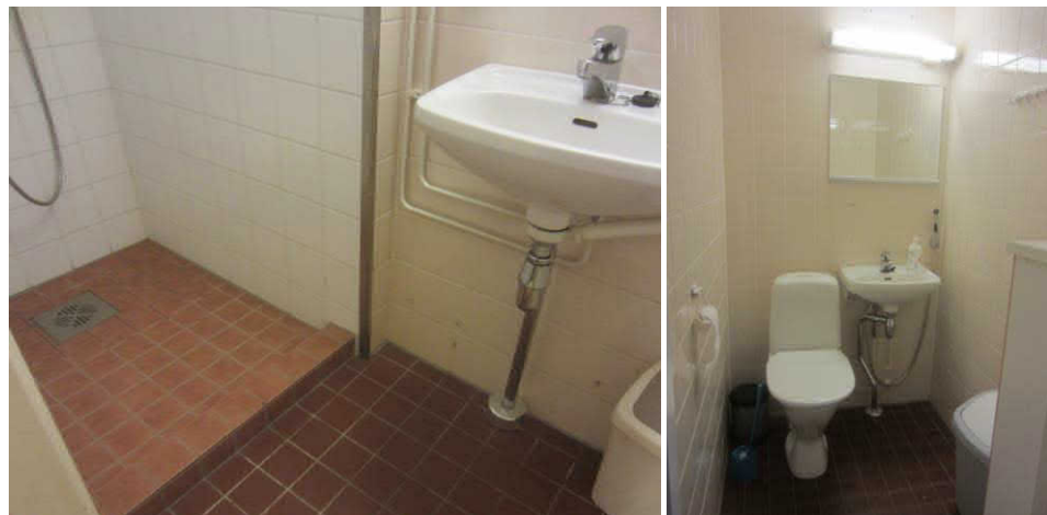
Suihku- ja wc-tiloja ja eri-ikäisiä laatoituksia (AAM / Malmberg).
