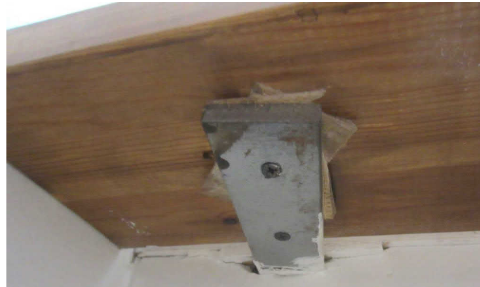
Alkuperäisiä ikkunalaudan kannakkeita on säilynyt, puuosissa on huomattavan iäkkäitä ja uusia, osa ikkunalaudojen kannakkeista on uusittuja (AAM / Malmberg).
