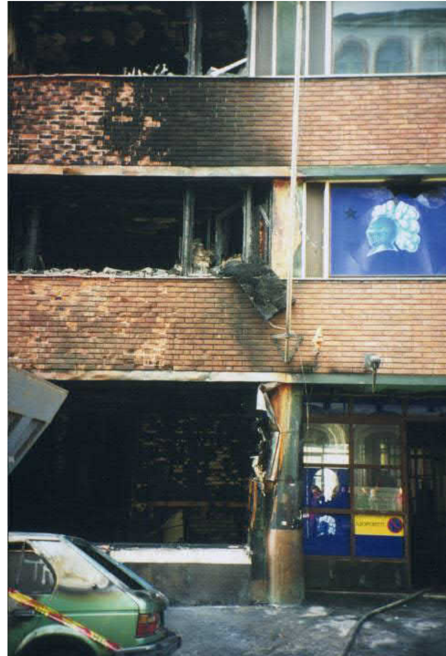
Julkisivua tulipalon jäljiltä maaliskuussa 1997 (AAM 100947 / Jouko Seppänen).
