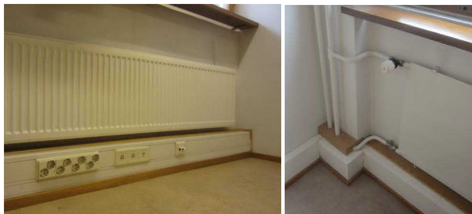
kerroksessa 1997 uusitut levypatterit, 3.–5. alkuperäiset (AAM / Malmberg).
