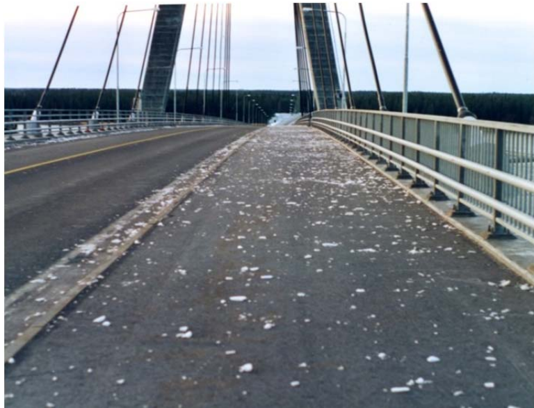
Kuva 20: Raippaluodon sillan köysistä tippunutta jäätä siltakannella (valokuva vuodelta 1999, R. Kiviluoma).
