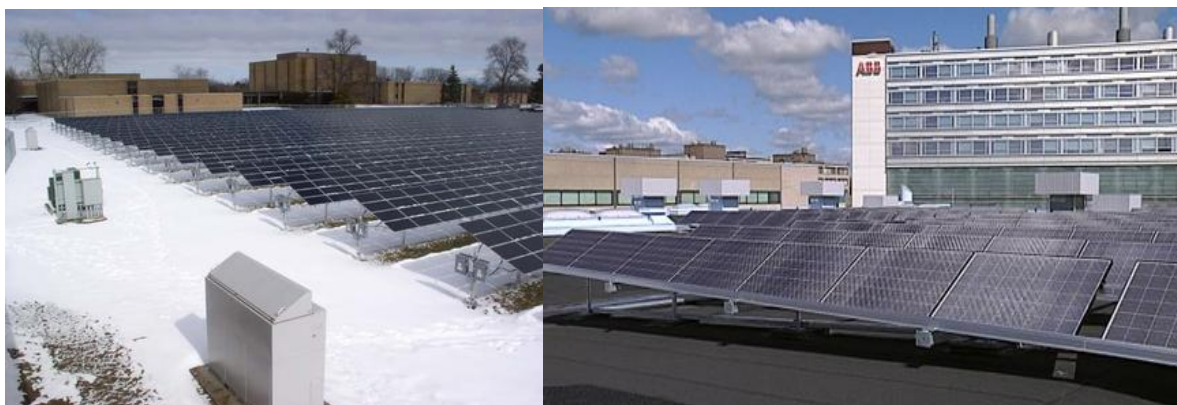
Kuva 3-2. Aurinkokennoja (ohutkalvo-lasilla-tyyppi) Toledon yliopiston kampuksella 260 kW:n ja 100 KW:n inverttereillä (PV Powered) verkkoonliitettyinä [Kuva: Business Wire] ja 870 kennon 160 MWh/v aurinkovoimala ABB:n kiinteistöjen katolla Helsingissä
