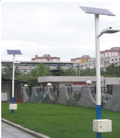
Kuva 4-22. 40 W led-katuvalaisin, joka on varustettu 50 W aurinkopaneelilla ja 100 Ah:n akulla. [Lähde: Solartechpro]
