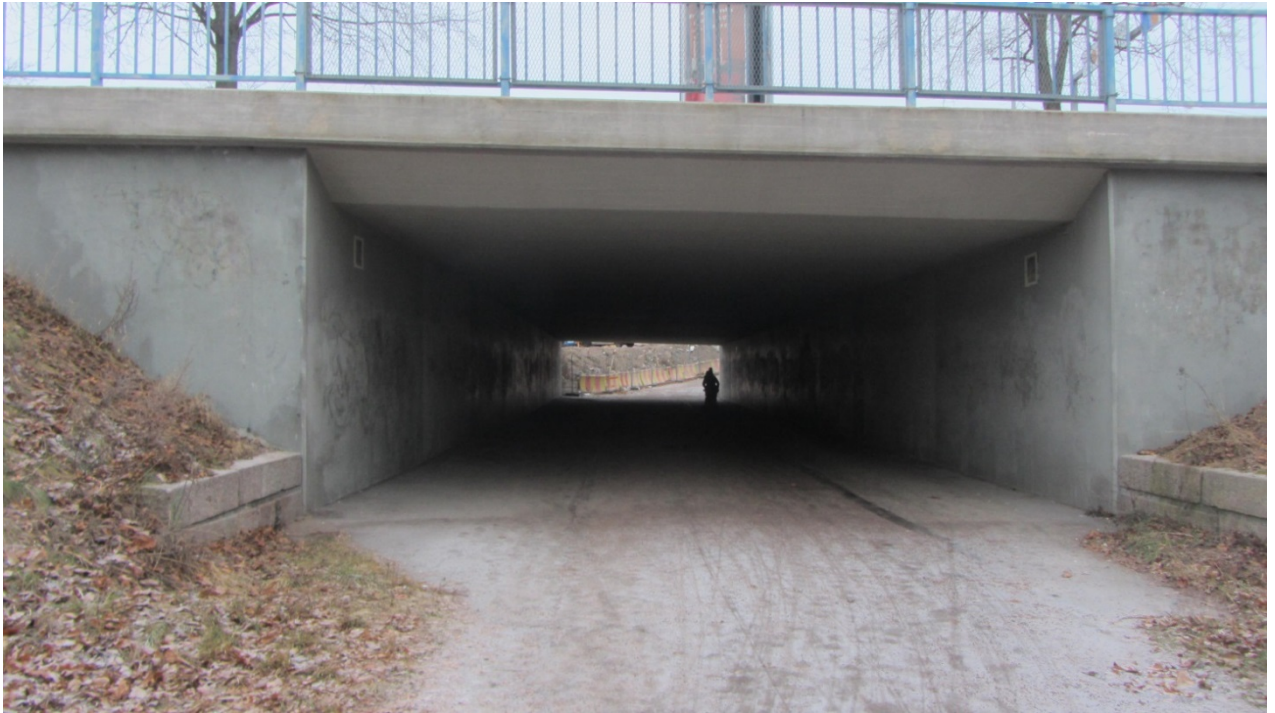
Kuva 11. Turvallisen alikulun houkuttelevuutta olisi hyvä parantaa. Valaistusolosuhteiden kehittäminen parantaisi oppilaiden turvallisuudentunnetta alikulussa.
