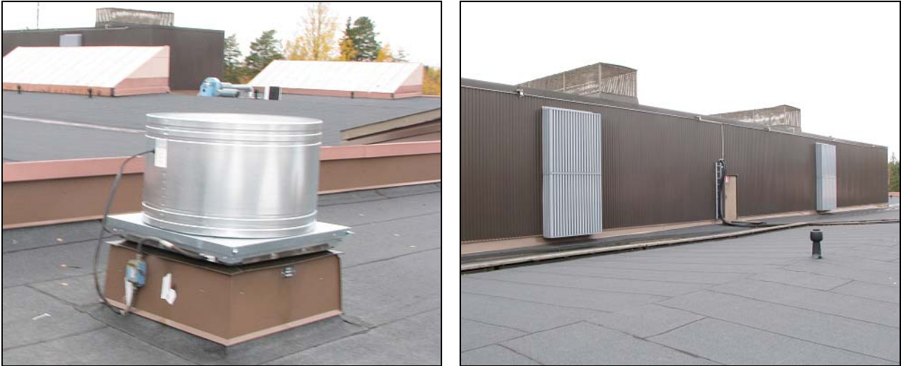
Kuva 3. (vasen) Uusi melulähde (puhallin ED12); (oikea) IV-yksiköt ED8 (ottosäleiköt kopin seinällä ja poistoyksiköt sen katolla).
