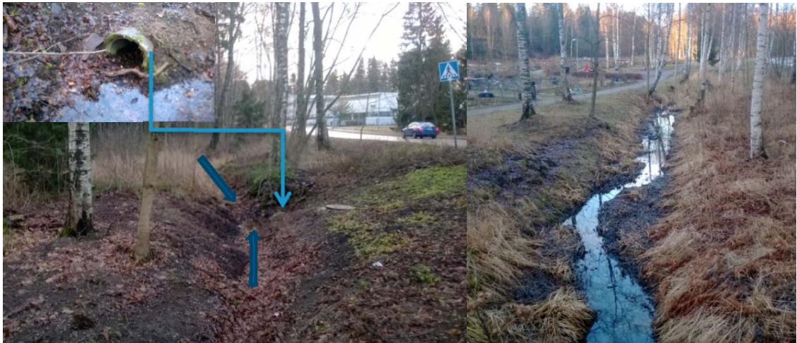
Kuva 41. Alppiruusupuiston luoteisosan uomaston purkupiste Aino Acktén tien alitse johdetaan rumpuun (vas.) ja tien länsipuolen uoma. Tien alittavaan rumpuun (800B) tulee puiston vesien lisäksi valuntaa 600B hulevesiviemäristä noin 10 hehtaarin alueelta puiston pohjoispuoleiselta asuinalueelta
