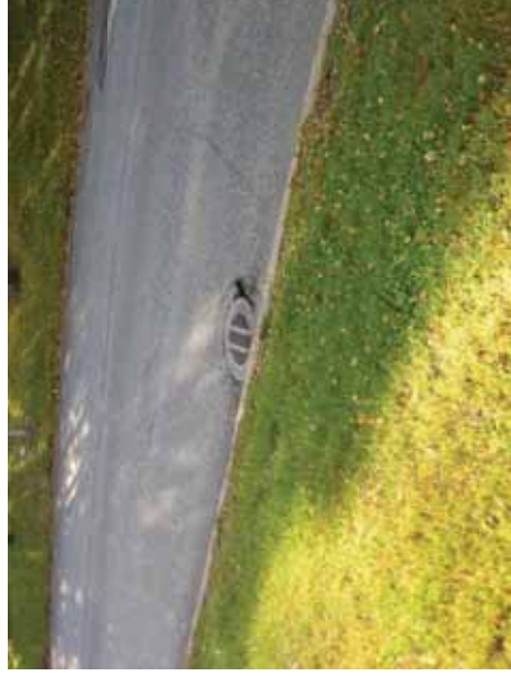
Kuva 36. Reikä päälysteessä kaivon vieressä.
