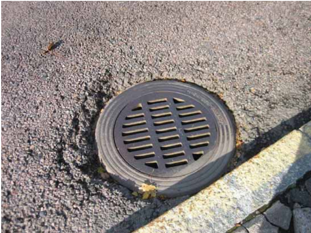
Kuva 6. Päällyste purkautuu sadevesikaivon reunasta. Katuinventointikartalla kuva nro 7.
