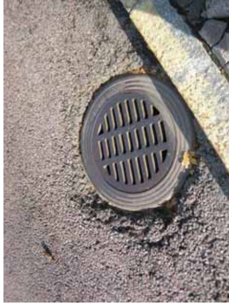
Kuva 7. Päälyste reikiintynyt kaivon vierestä.
