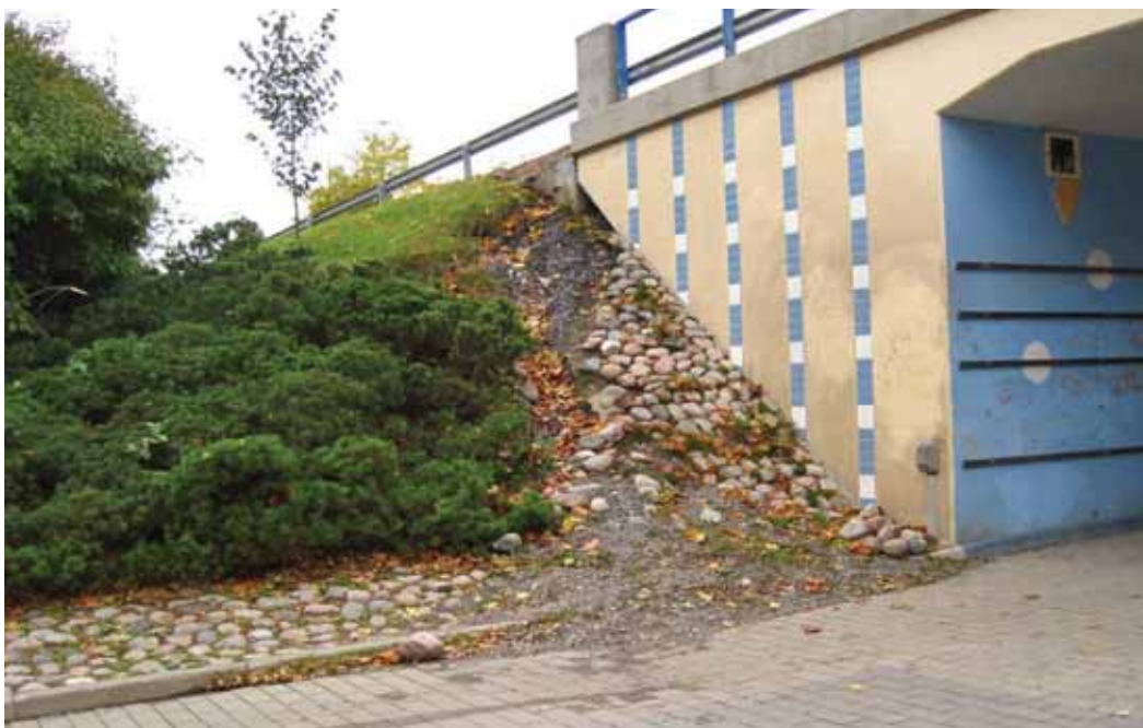
Kuva 30. Emännänpolun alikulun eteläpuolen luiskaverhous on purkautunut. Katuvihreän inventointikartalla kuva nro 12.
