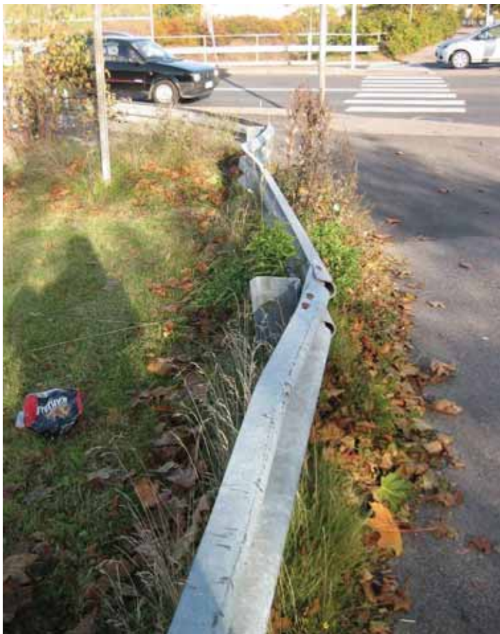
Kuva 7. Huonokuntoinen ajojohde. Katuinventointikartalla kuva nro 15.
