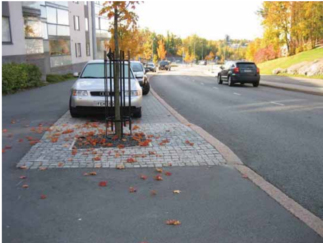
Kuva 5. Mellunmäentien alku on erinomaisessa kunnossa. Katuinventointikartalla kuva nro 60.
