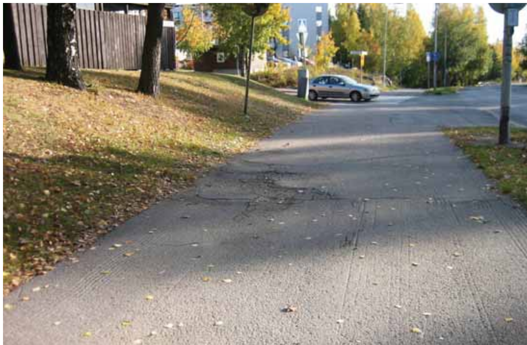
Kuva 8. Puiden juuret kohottavat ja rikkovat päällystettä Mellunmäentien kevyen liikenteen väylällä. Katuinventointikartalla kuva nro 46.
