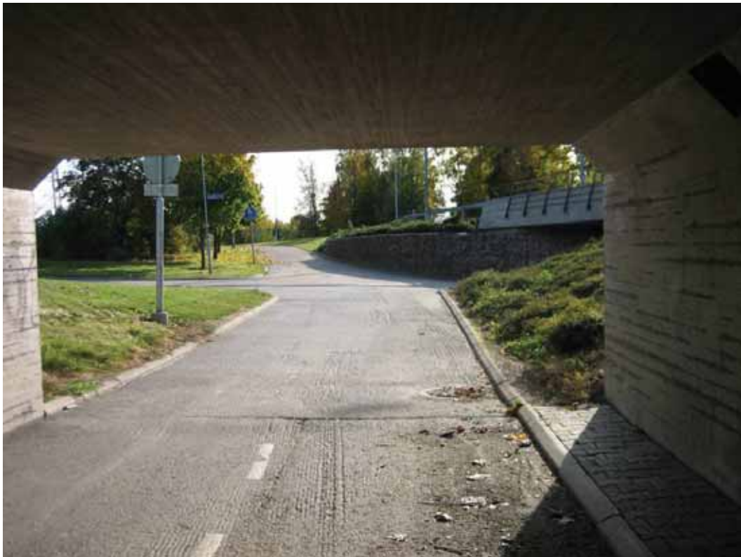
Kuva 10. Länsimäentien alikulku: näkemä on puutteellinen oikealle Mellunmäentien ali kulkeville Länsimäentien suuntaan. Samoin Länsimäentien alittavilla on puutteellinen näkemä vasemmalle. Inventointikartalla nro 22.
