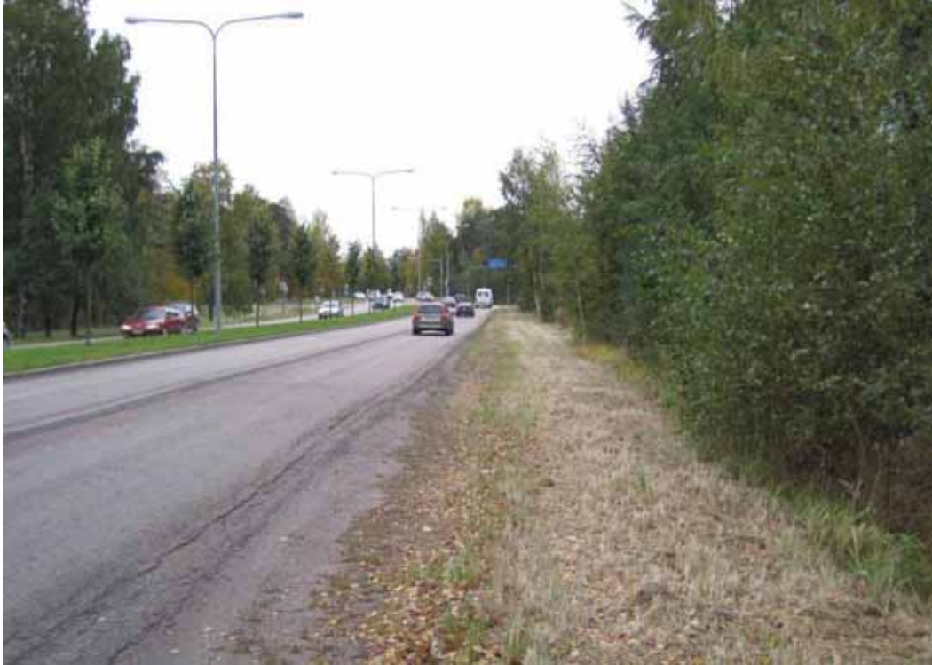
Kuva 25. Tuhoutunutta "nurmea" ja murtunut päällysteen reuna. Katuvihreän inventointikartalla kuva nro 7.
