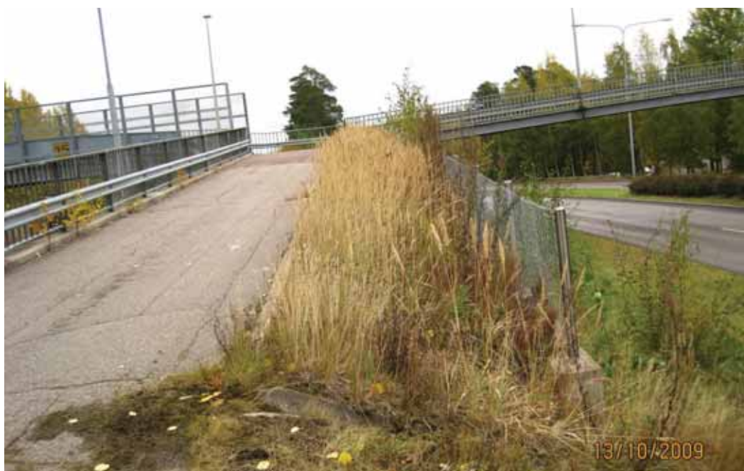
Kuva 29. Hoitamaton välialue Tanhuantien liittymän itäpuolella olevan ylikulkusillan luiskassa, katuvihreän inventointikartalla kuva nro 22.
