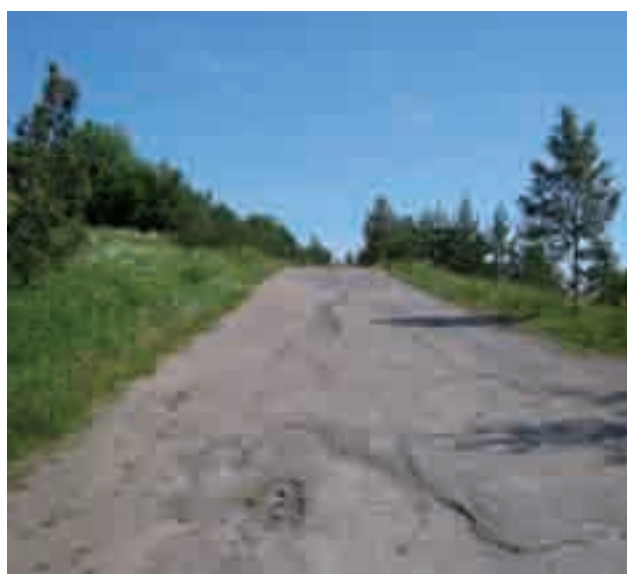
Kuva 19. Rinteen huonokuntoista asfalttia.
