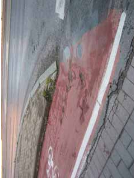
Kuva 70. Pyörätien päässä reikiä ja epätasaisuutta Kirkonkyläntiellä.
