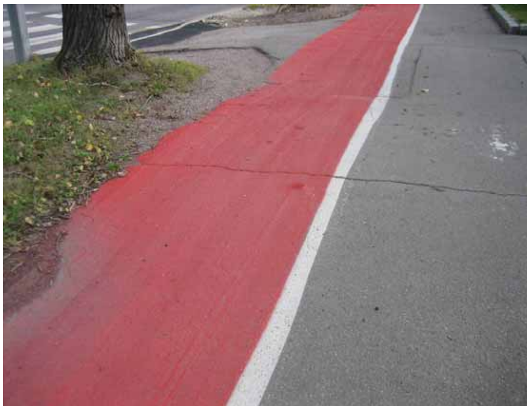
Kuva 6. Kevyen liikenteen väylällä painumaeroista aiheutuvia pituusepätasaisuuksia, kuntoluokka 3, kuva Latokartanontieltä on Vilppulantien liittymäalueen läheisyydestä, eteläpuoleiselta kevyen liikenteen väylältä. Katuinventointikartoilla kuva nro 78.
