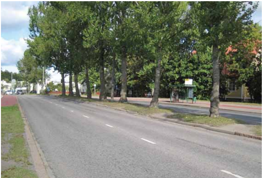
Kuva 15. Poppelin juuret tuhoavat keskikaistan reunakivet Kirkonkyläntiellä ja jatkossa todennäköisesti ajoradan päällysteen. Inventointikartalla kuva numero 24.
