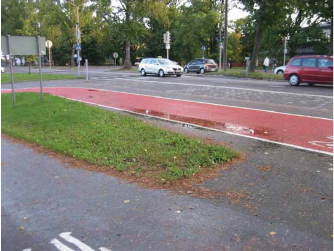
Kuva 7. Kevyen liikenteen väylän pinnalle kertyy sadevesiä, kuva on otettu Kirkonkyläntieltä Malmin kirkon edestä. Katuinventointikartoilla kuva nro 36.
