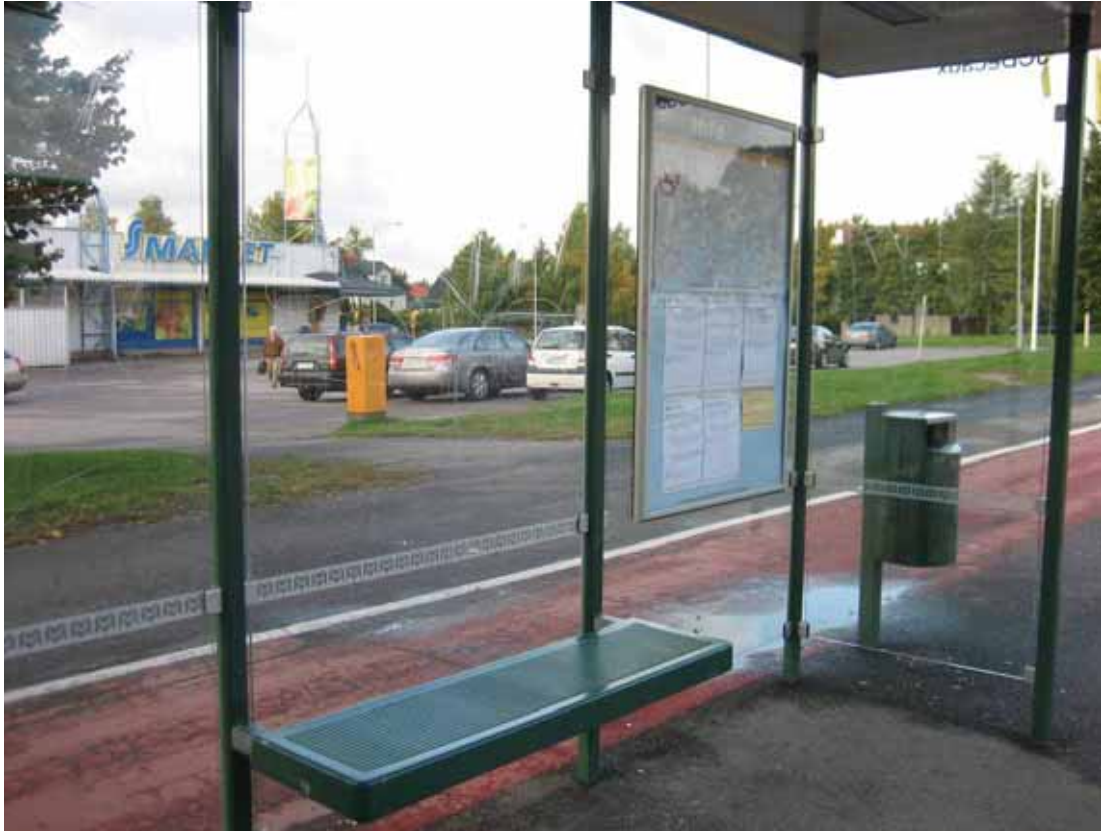
Kuva 10. Bussipysäkki on hyväkuntoinen lukuun ottamatta pysäkkiä sivuavan väylän vettä kerääviä painanteita Kirkonkyläntiellä. Katuinventointikartoilla kuva nro 24.
