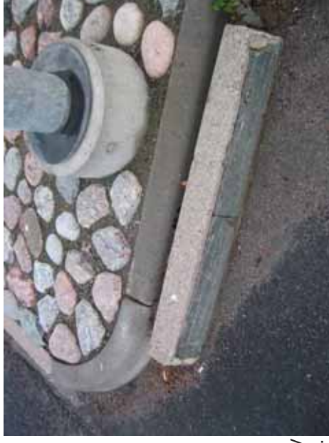
Kuva 19. Ylimääräinen reunakivi jätetty keskelle saareketta Kirkonkyläntiellä.
