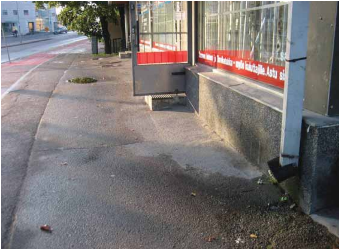
Kuva 8. Sadevesiä johdetaan hallitsemattomasti kevyen liikenteen väylälle, kuva on otettu Kirkonkyläntieltä Malmin aseman läheltä, etelän puoleiselta kevyen liikenteen väylältä. Katuinventointikartoilla kuva nro 66.
