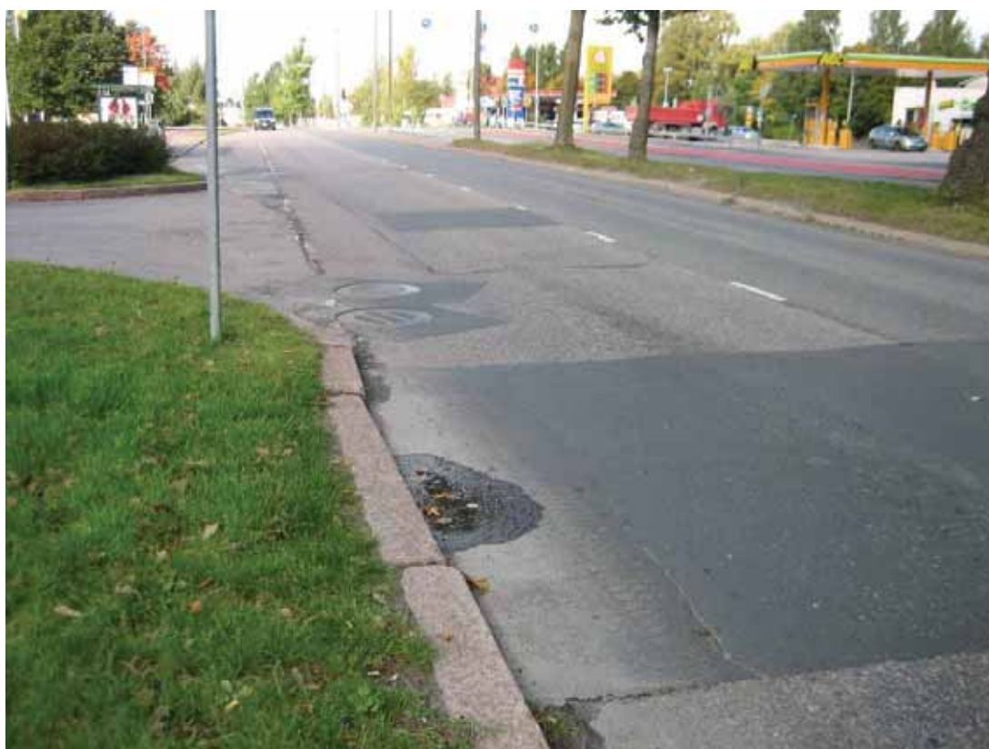
Kuva 3. Kuntoluokka 2, kuva otettu Kirkonkyläntieltä läheltä Takaniitynkujan liittymä. Katuinventointikartoilla kuva nro 28.
