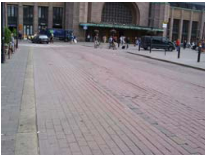
Keskusta: Elielin aukion bussi-terminaalin painunut päällyste.
