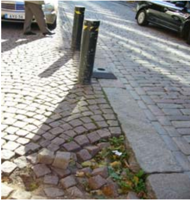
Keskusta: Rikottu pollari. Myös päällyste on vaurioitunut.
