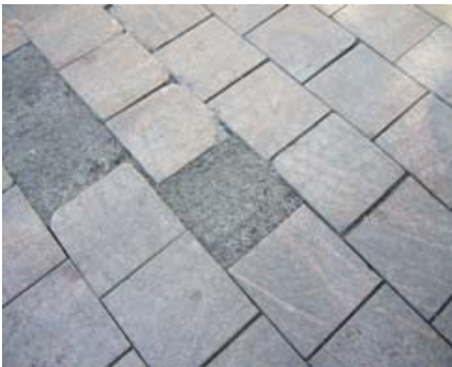
Keskusta: laatoitusta on jouduttu paikkaamaan asfalttipaikoilla. Alkuperäisen, epätavallisen materiaalivalinnan vuoksi oikeita laattoja ei ole ollut saatavilla.
