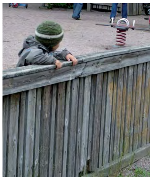
Tämän leikkipuiston aita ei täytä turvallisuusvaatimuksia. Aita on liian matala ja rikkiäinen. Kuva: Taija Poutiainen
