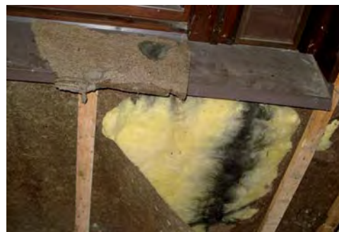
Lämmöneristeiden likaa huullaan usein homeeksi. Kuva: Taija Poutiainen.
