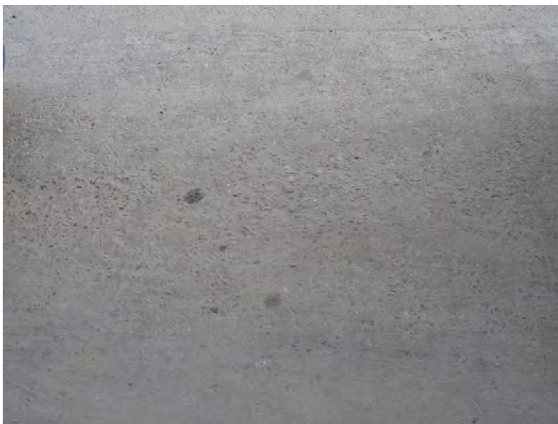
Kuva 13. Kadun pintarakenteisiin jää puhdistuksen ja pesun jälkeen talviaikana tiivistynyttä hienoaainesta. Kuva: Jari Viinanen.
