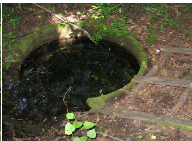
Kaivonrengas, joka olisi mahdollista poistaa.
