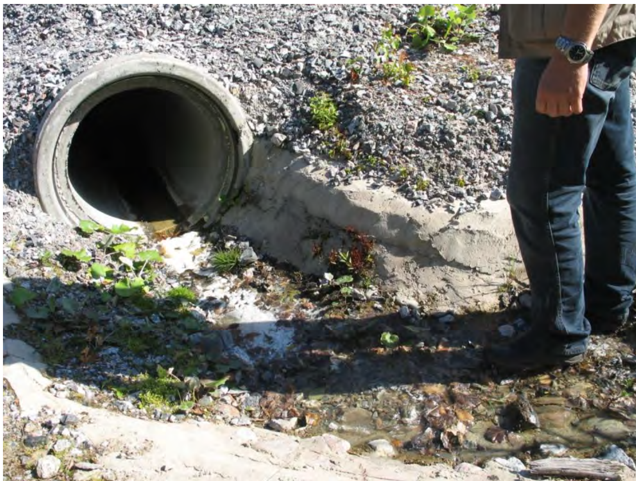
Peitetyn lähteen vesi tulee ojaan betoniputkessa.
