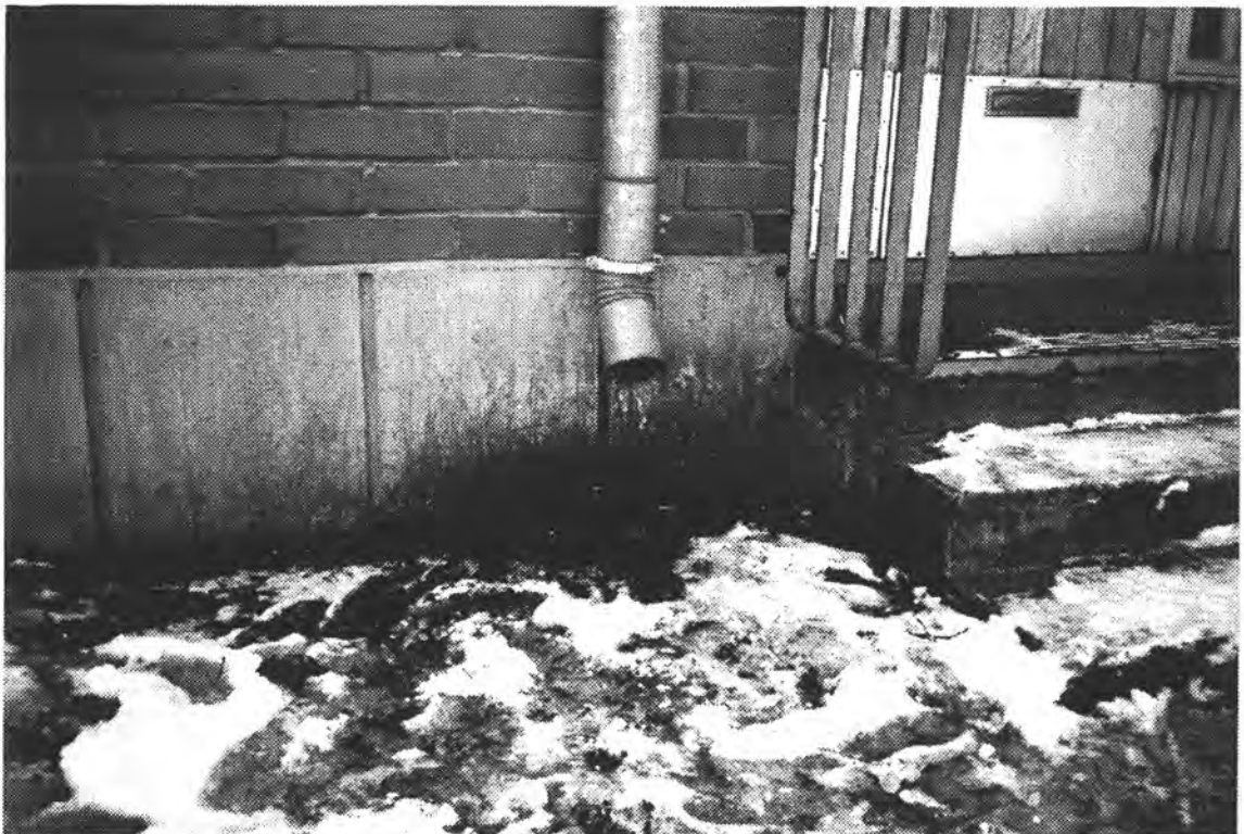
Kuva 2. Sadevesien ohjausta ei ole järjestetty. Puotilan päiväkot.
