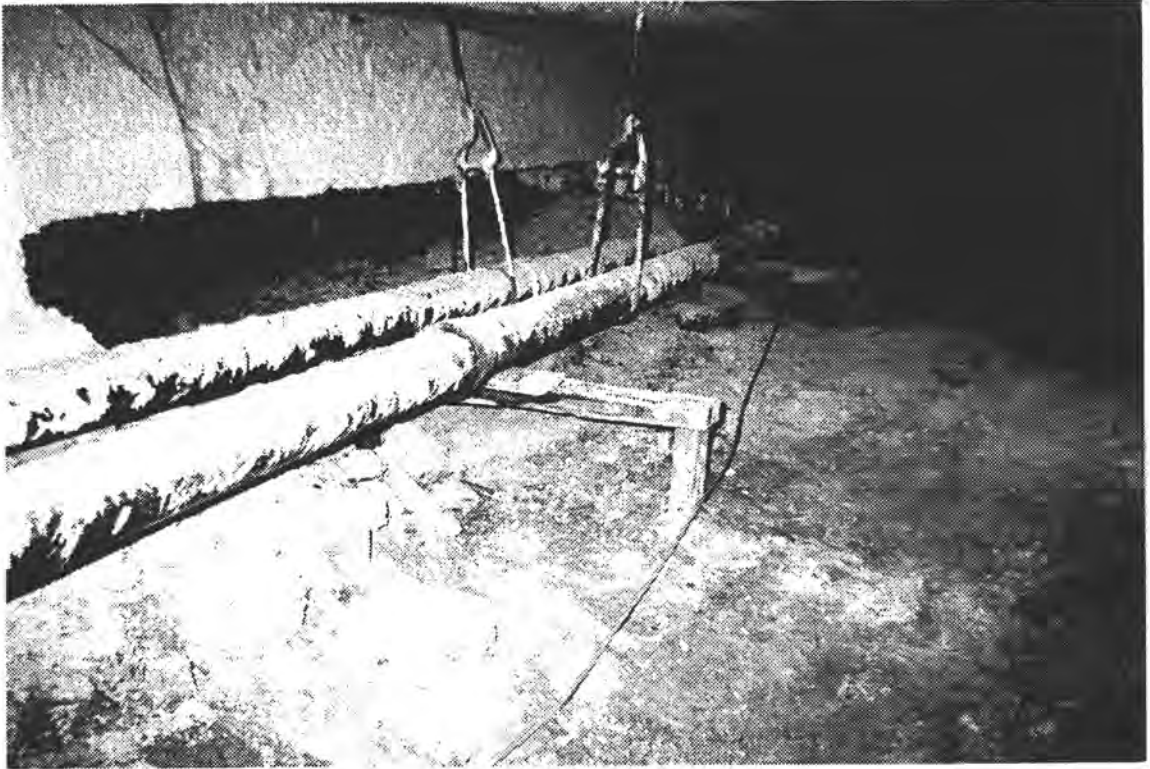
Kuva 5. Eristämättömiä putkia, jotka on tuettu puurakenteilla. Solakallion koulu.
