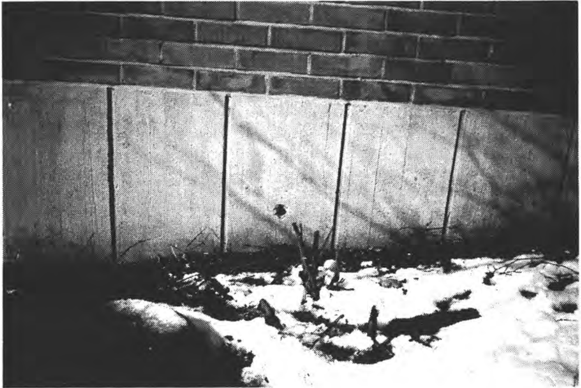
Kuva 3. Liian pieni tuuletusaukko. Puotilan päiväkot.
