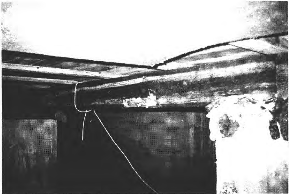
Kuva 1. Lahon vaurioittama primääripalkki. Kannelmäen ala-asteen sivukoulu.
